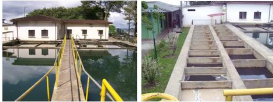
Figura 15. Planta de tratamiento de agua Tulcán.
