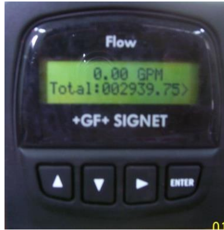
a. Transmisor de Caudal + GF SIGNET 8550-1
