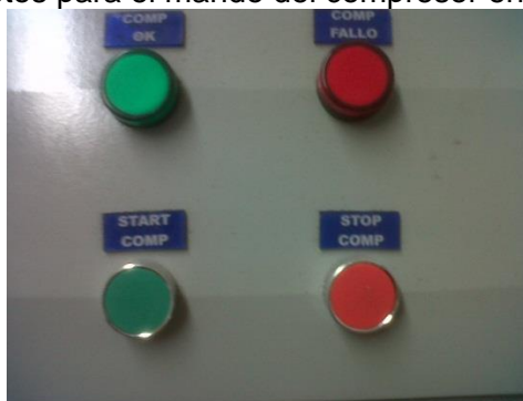
Figura C.6. Pulsadores y pilotos para el mando del compresor en el panel HMI.
