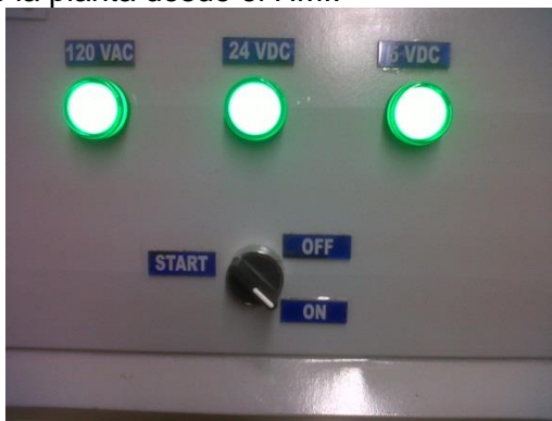
Figura C.4. Encendido de la planta desde el HMI.
