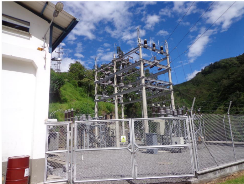
Imagen 3.4 Subestación Principal [Fuente: Propia]
