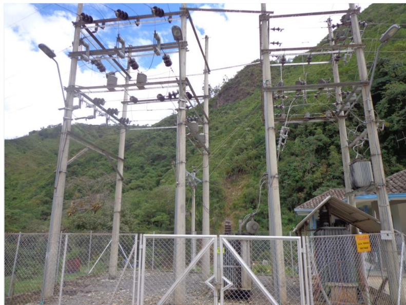
Imagen 3.6 Subestación Municipio Puracé, Cabecera Municipal Coconuco [Fuente: Propia]
