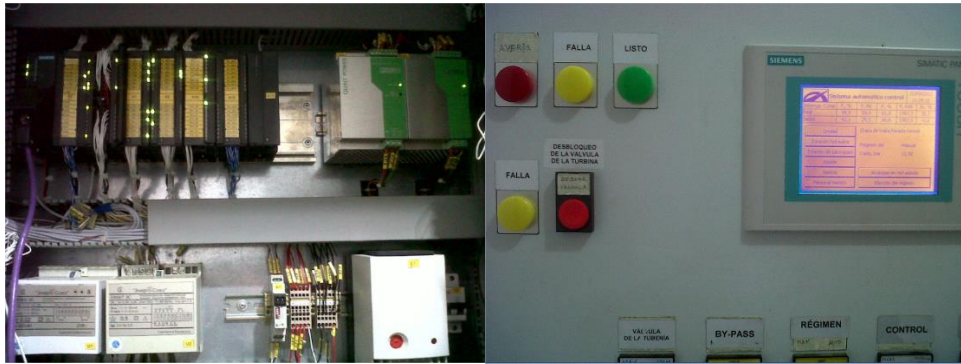
Imagen 3.3 PLC y HMI SIEMENS [Fuente: Propia]
