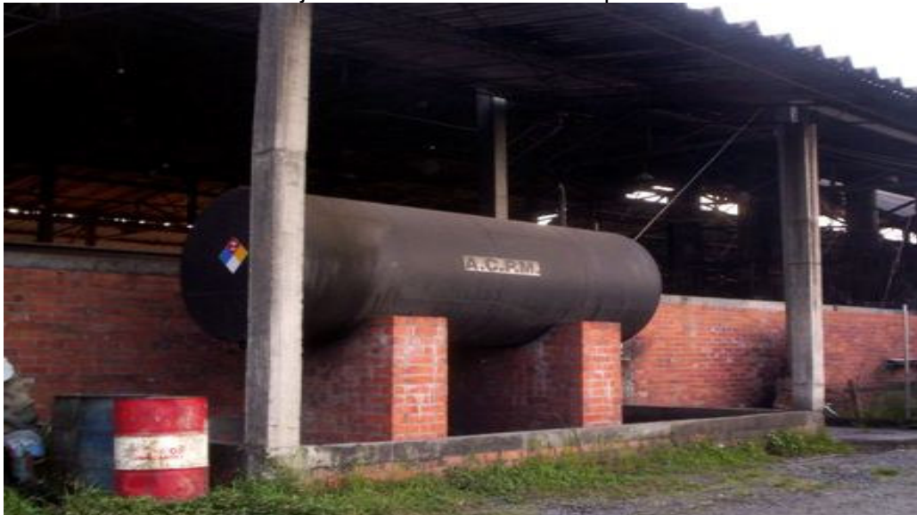
Figura 1.3. Zona de almacenaje de A.C.P.M ubicada en planta 1.
