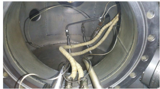
Figura B.36. Cables Horno
