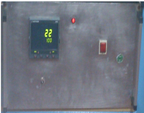
Figura B.24. Vista frontal gabinete control temperatura
