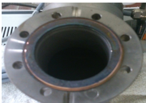
Figura B. 28. Primeras fugas detectadas, debidas a orrín de cobre sucio y/o reutilizado. Fuente propia
