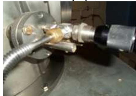
Figura 2.16. Válvula de flujo de entrada argón a la cámara. [Fuente propia].
