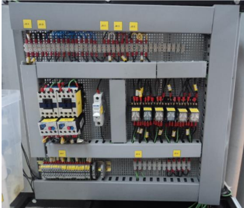
Figura 17 Panel de Control de Mando.
