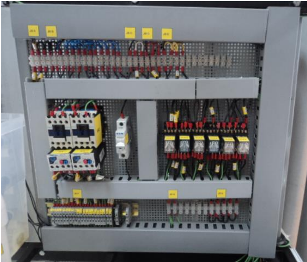
Figura 0.8 Panel de Control de Mando.
