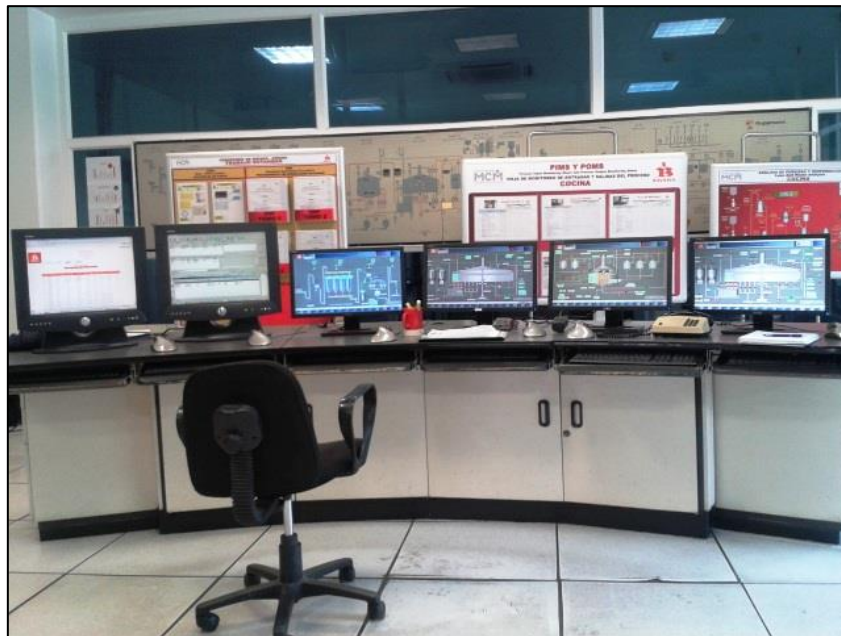
Figura 23. Servidores Intouch e InBatch cuarto de control Bavaria Boyacá
