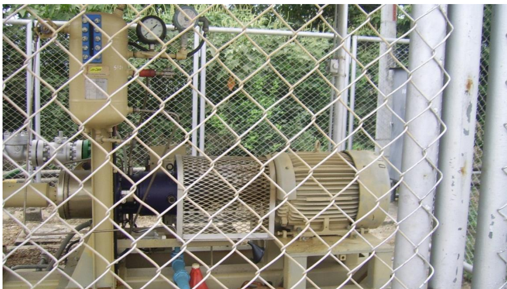
Figura 1.14. Bombas horizontales de inyección de agua, Campo San Francisco Neiva – Huila. Fuente propia.
