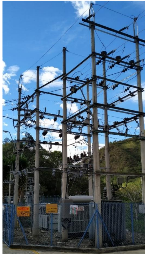
Figura 2. Subestación de generadores 1 y 2. PCH Coconuco. Fuente: Propia
