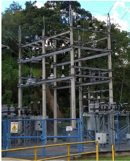
Figura 3. Subestación Generador 3. PCH Coconuco. Fuente: Propia
