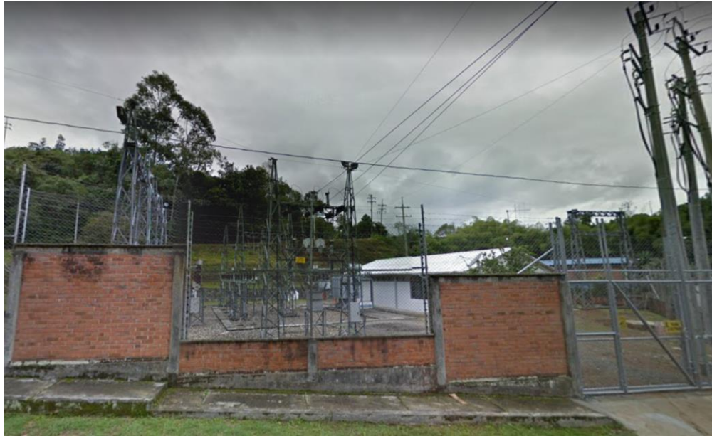
Figura 5. Subestación Centro, Popayán. Fuente: Propia
