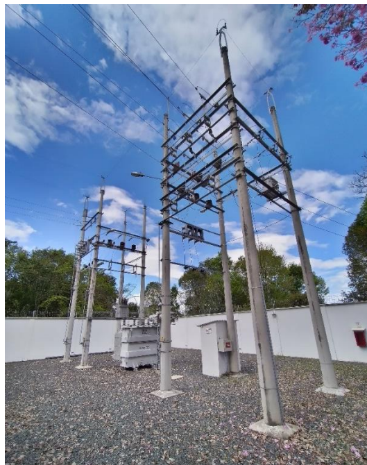
Figura 4. Subestación Tulcán, Popayán. Fuente: Propia
