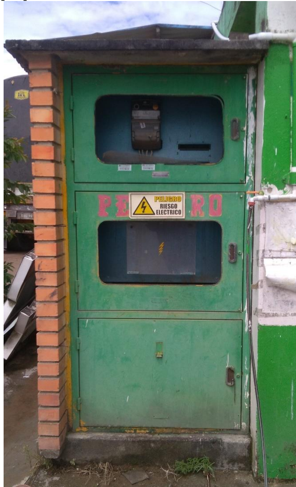
Figura 28 Medidor de energía Semi-directa. Fuente elaboración propia.
