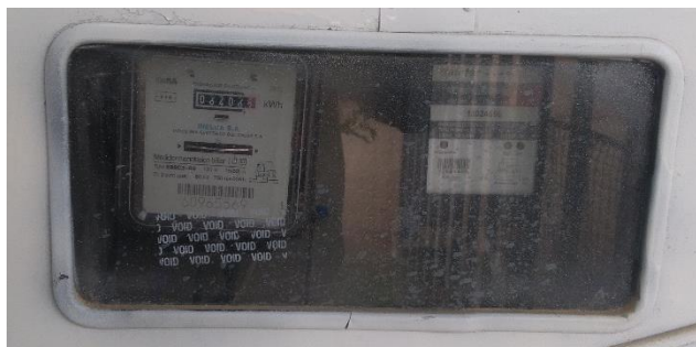
Figura 29 Medidor de energía directa. Fuente elaboración propia.
