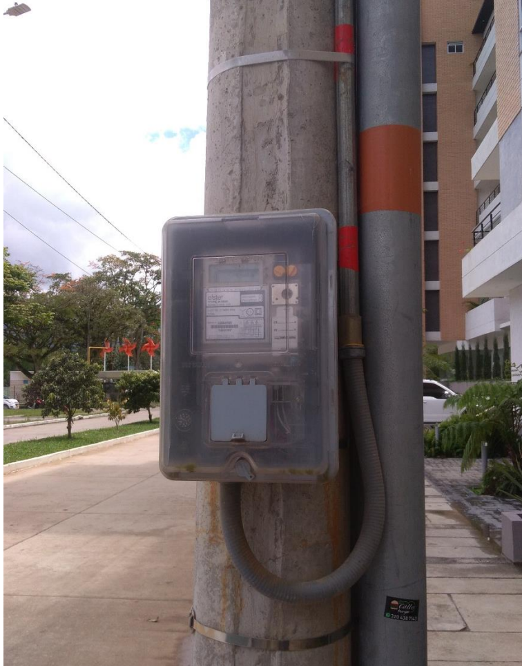
Figura 27 Medidor de energía indirecta en poste. Fuente elaboración propia.
