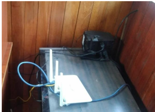
Fig. 55. Estación de cliente, instalación dentro a la vivienda.
