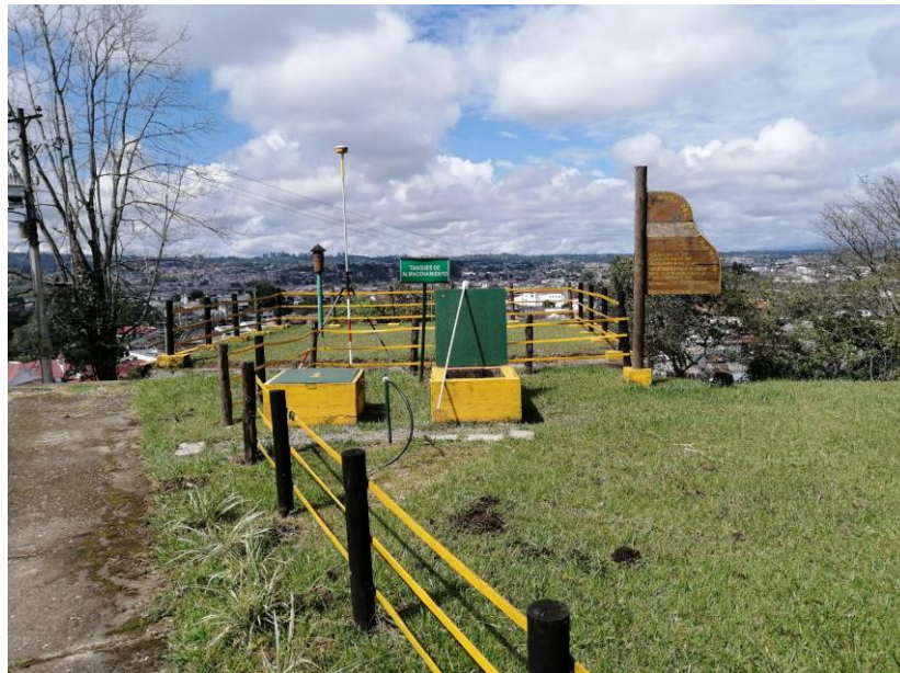
Figura 3.3: Tanque de almacenamiento Fuente: Propia.
