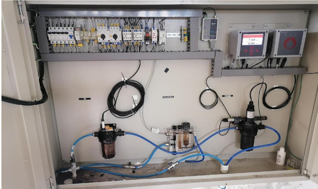
Figura 3.12: Gabinete de salida instalado en 2020. Fuente: Propia.
