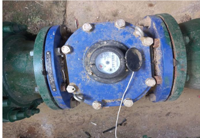
Figura 4.20: Display macromedidor mecánico.
