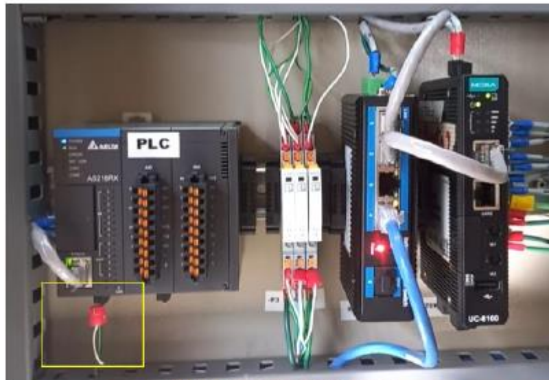
Fig 3. Cables Modbus PLC AS200.
