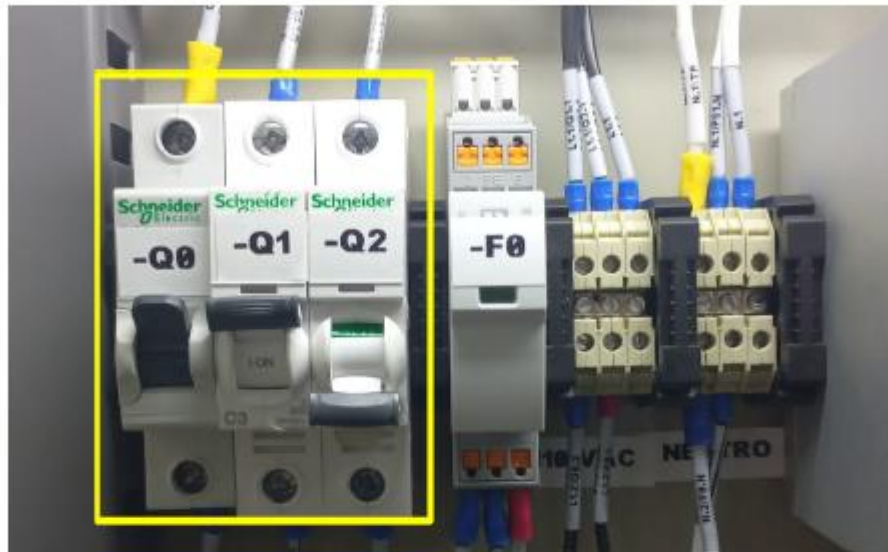
Fig 2. Interruptores Q0, Q1 y Q2.
