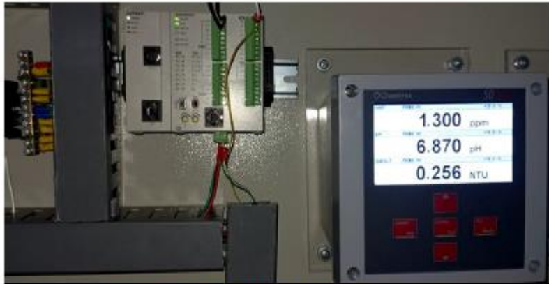
Fig 4. Gabinete de Salida.
