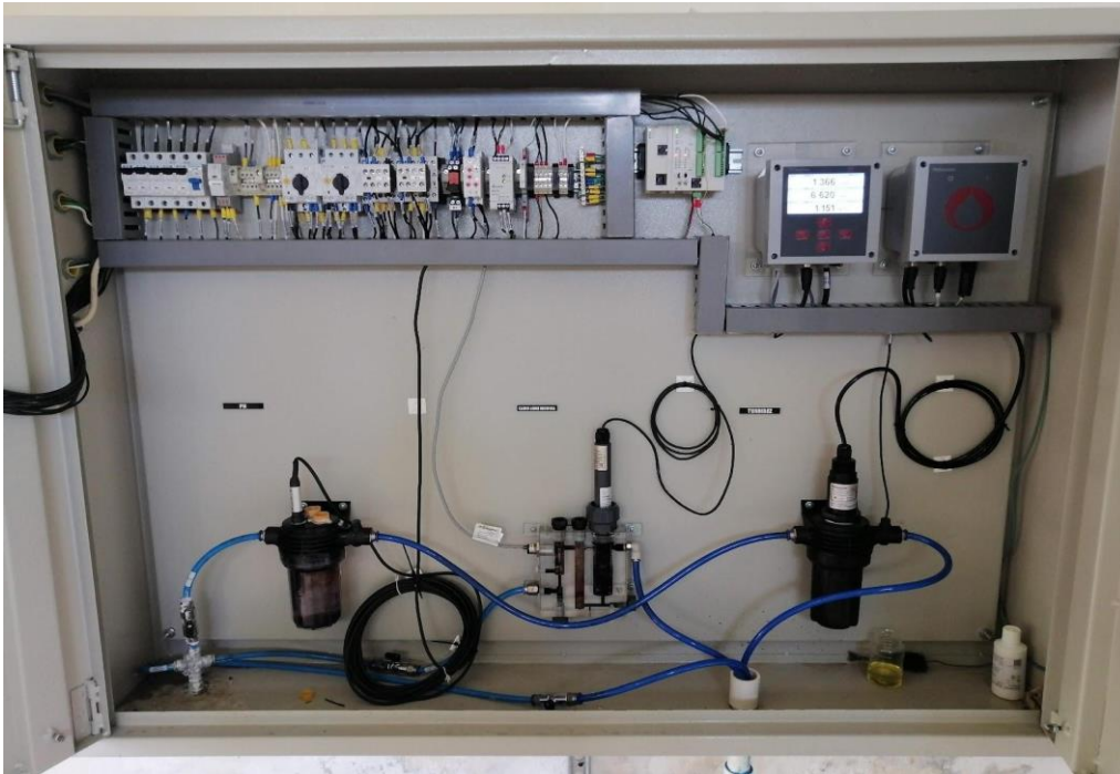
Figura 4.7: Instalación PLC gabinete de Salida. Fuente: Propia.
