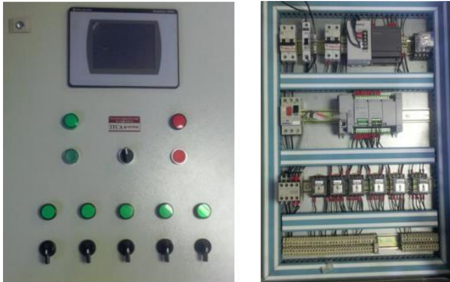
Figura 2.8 Sistema de control de riego para invernadero.
