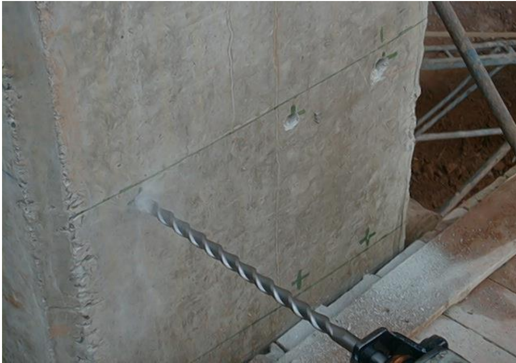
Foto No. 23 Perforación para colocación de anclajes para vigas de carga de escaleras
