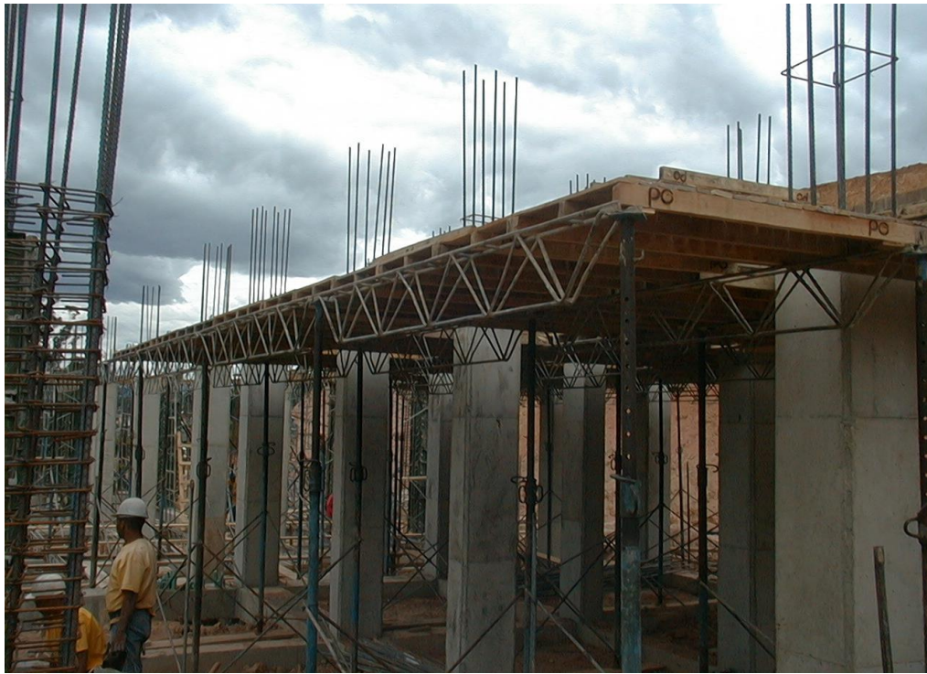
Foto No. 11 Armado de sistema de apoyo para construcción de losa de segundo piso
