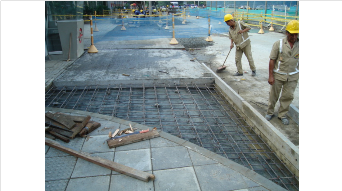
Doble parrilla colocada bajo cárcamo frente al Centro Comercial Cosmocentro
