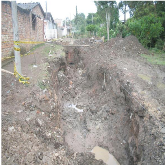
La inestabilidad del terreno llevo a que se presentaran derrumbes en la excavación
