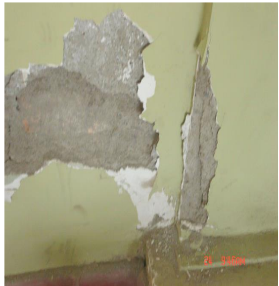
Se puede un desprendimiento muy avanzado del repello del muro.
