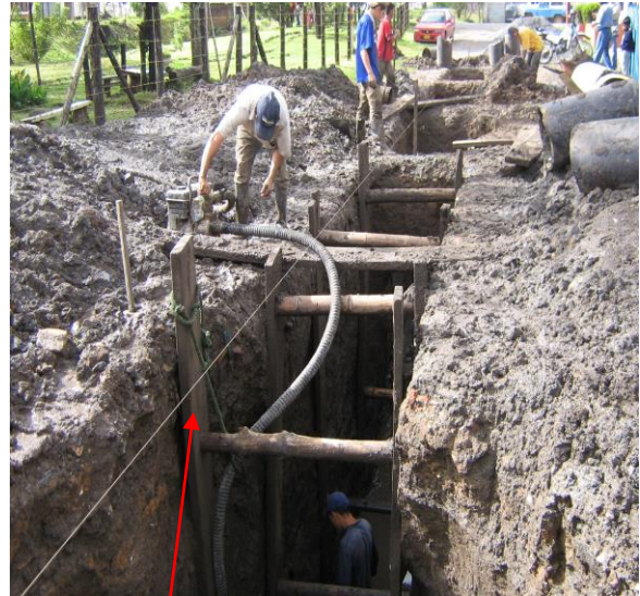
Excavación entibada, se observa trabajo de bombeo para controlar nivel del agua. Pobreza en el entibado, lo que permite presumir riesgos para los obreros.
