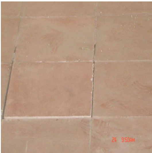
Se puede ver claramente la falta de lechada para sellar las juntas entre las baldosas de cemento. Se observo desprendimiento de baldosas.
