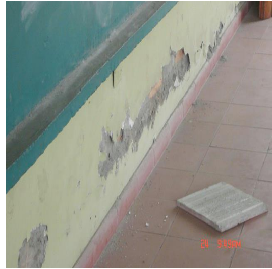
El deterioro en este salón es localizado.
