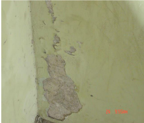
Se observa el pésimo estado del repello
