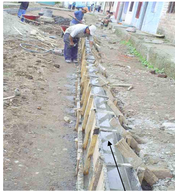
Claramente se observa que el vaciado fue concluido y se comienza proceso de fraguado del concreto.
