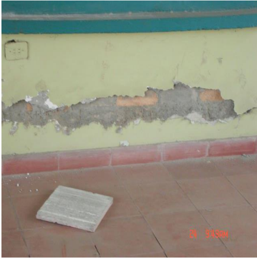
Se observa deterioro en la pared y piso
