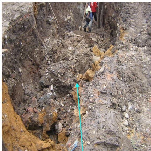
El no tener en cuenta las características del entorno, conllevó a no considerar acciones preventivas como entibado de las excavaciones
