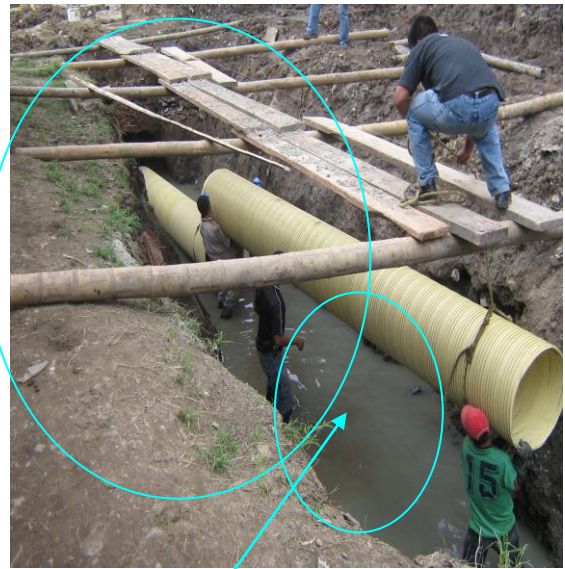
Se observa nivel freático alto, presentándose inconvenientes en la instalación de las tubería, debiéndose mejorar el suelo de cimentación.
