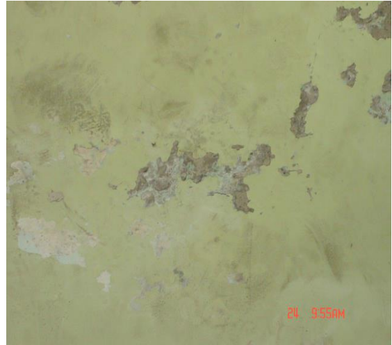
Se observa que el daño es general
