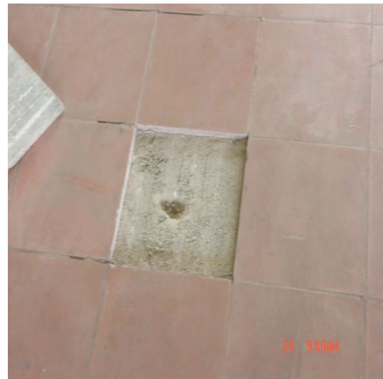
Se observa el fácil desprendimiento de las baldosas de cemento, además se puede ver que la baldosa no esta pegada, ( esta simplemente puesta)
