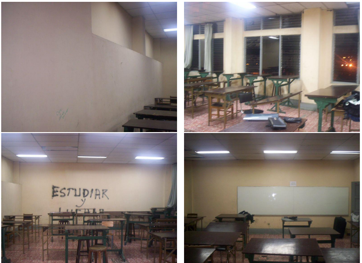
Fotografía 3 Detalles de los cuatro flancos del salón. Flancos occidental y oriental –arriba izquierda y derecha: muro con vista al exterior del edificio (calle) y muro divisorio del pasillo; flanco norte y sur- abajo izquierda y derecha: muro con tablero acrílico y muro anterior que colinda con otro salón.
