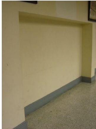
Fotografía 7 Parte exterior del muro divisorio que forma parte del conjunto total. Nótese que la columna afecta la continuidad de la superficie.
