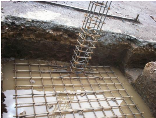
Foto 25 : Agua en la cimentacion
