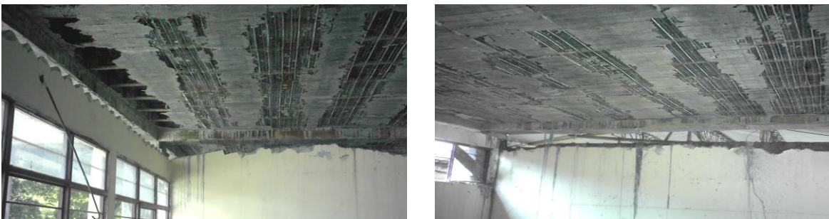
Losa Terminada y daños en las edificaciones existentes.
