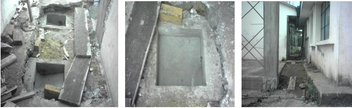
Construcción de la caja de inspección para redireccionar la tubería y evitar rompimiento de cimentación.
