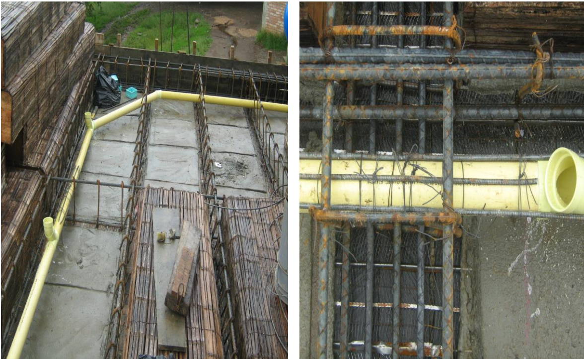
Tubería Conduit Reforzada
