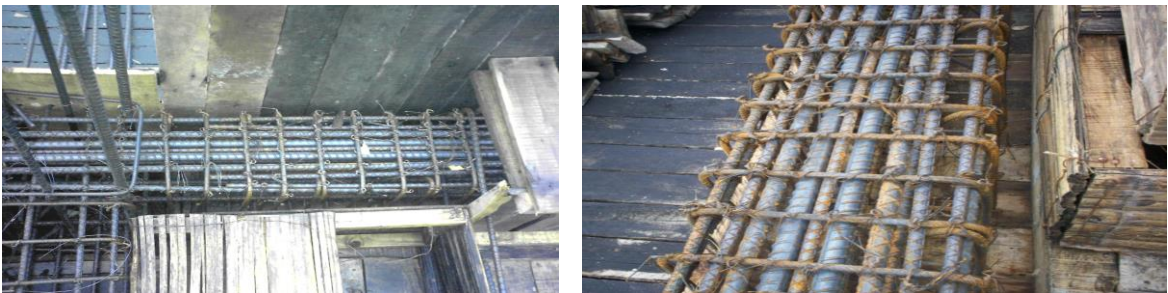
Viga con espaciamiento entre varillas < a 2.5 cm.
