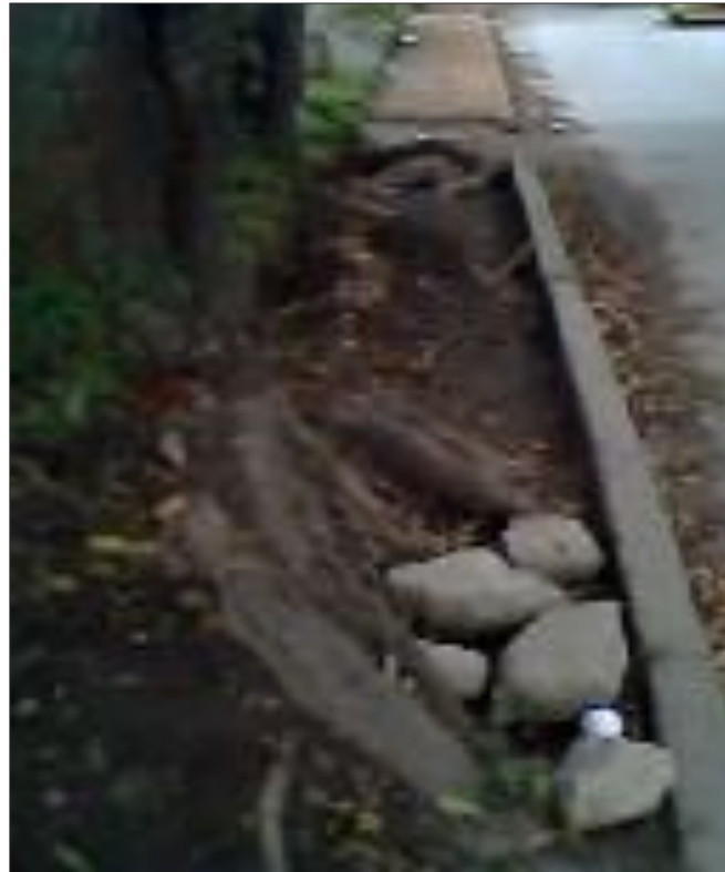
Ilustración 31. Raíces de árbol no presuestadas y que interrumpian la continuidad del andén.
