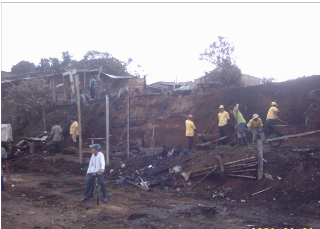
Ilustración 66. Trabajadores de la Secretaria de Infraestructura levantando madera y restos del incendio.
