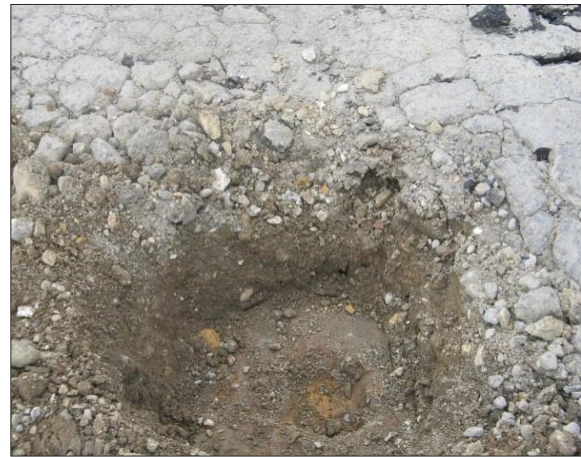
Ilustración 18. Apique realizado para conocer el estado de la estructura del pavimento existente. Entrada principal de la clínica La Estancia.
