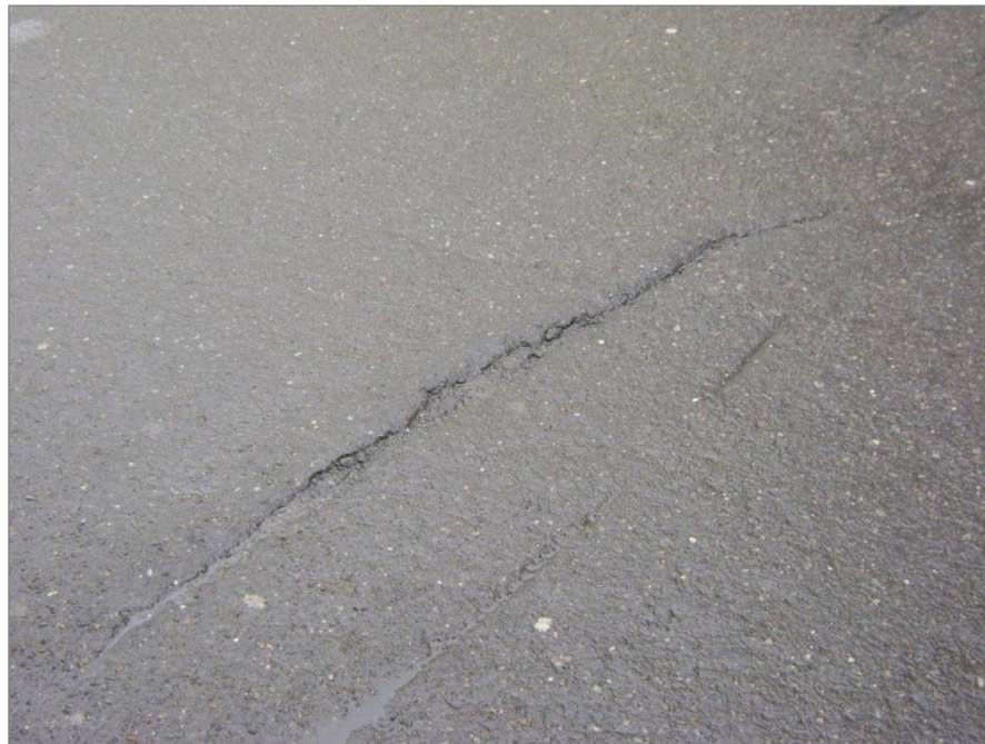
Ilustración 55. Ejemplo de Fisura lineal. Frente a Av Villas.
