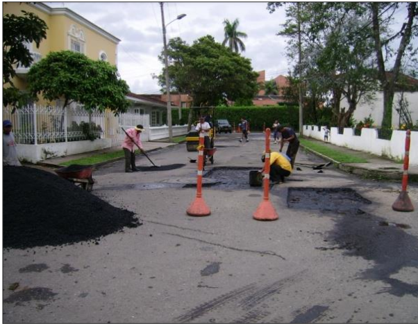
Ilustración 15. Suministro y colocación de la mezcla asfáltica tipo MDC-2. Calle 18N con carrera 16. Barrio Campamento.
