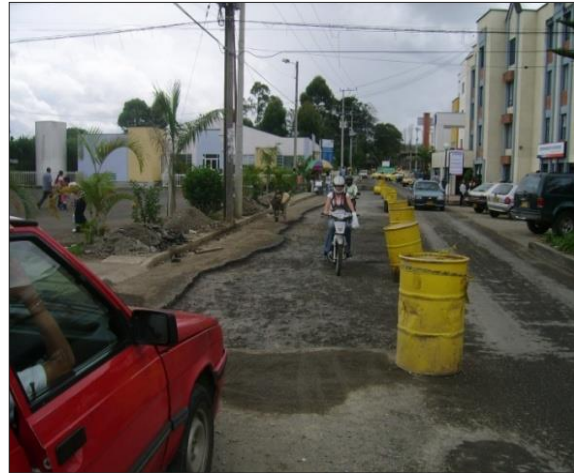
Ilustración 22. El transito pasa sobre la base compacta por falta de señalizacion. Entrada principal de la clinica La Estancia.
