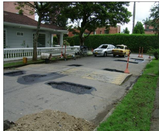
Ilustración 14. Baches imprimados. Calle 18N entre carreras 16 y 17. Barrio Campamento.
