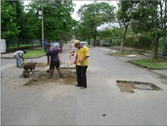
Ilustración 11. Demolicion de la carpeta asfáltica. Tramo sobre la carrera 17 desde la calle 18N hacia la calle 20 N. Barrio Campamento.
