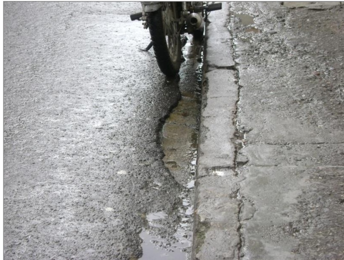
Ilustración 56. Ejemplo de Pavimento con grado de Daño 1. Calle 6 entre carreras 7 y 8.
