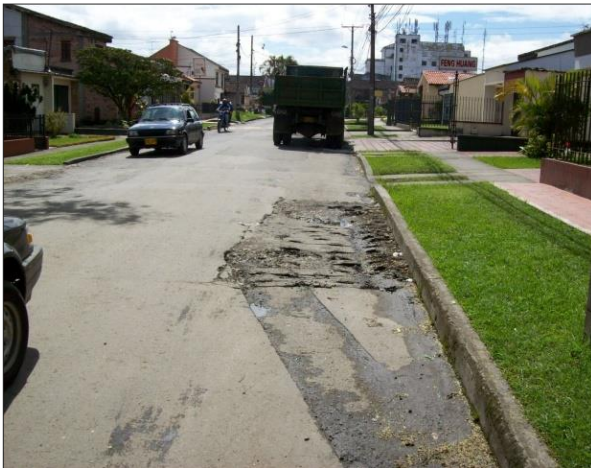
Ilustración 9. Estado inicial de las vías objeto del contrato. Tramo de la carrera 11 desde la calle 8N hacia la calle 18N. Barrio Santa Clara.
