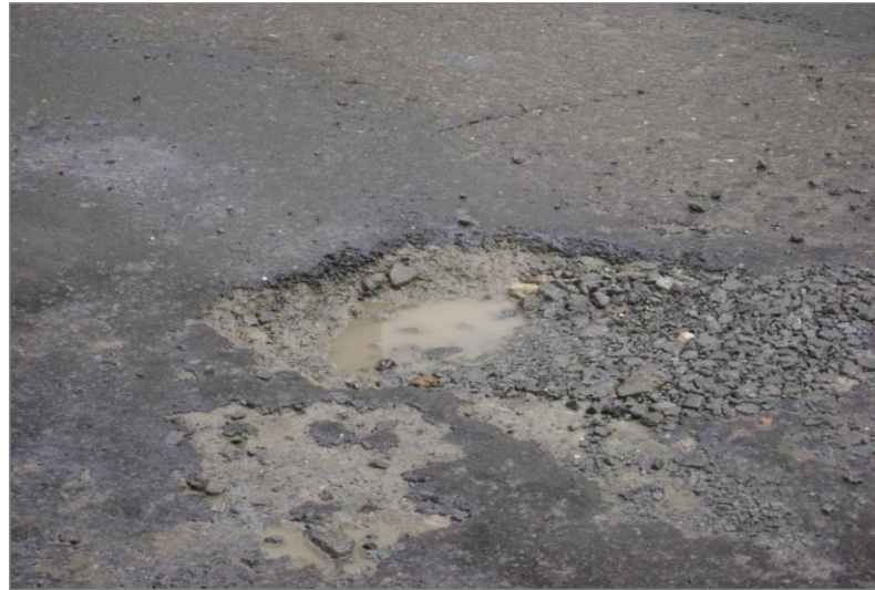
Ilustración 58. Ejemplo de Pavimento con grado de Daño 3. Frente a AV Villas. Centro de la ciudad.
