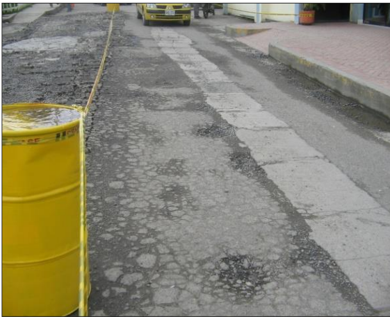
Ilustración 17. Estado inicial de la vía. Entrada principal de la clínica la estancia. Carrera 4 desde la calle 15N hacia urgencias de la clínica la estancia
