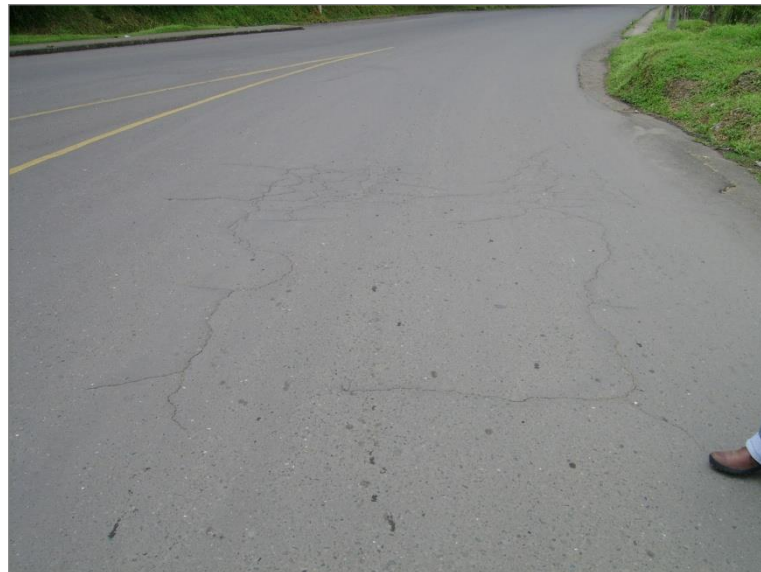
Ilustración 57. Ejemplo de Pavimento con grado de Daño 2. Piedra Norte hacia Puente de Cauca.
