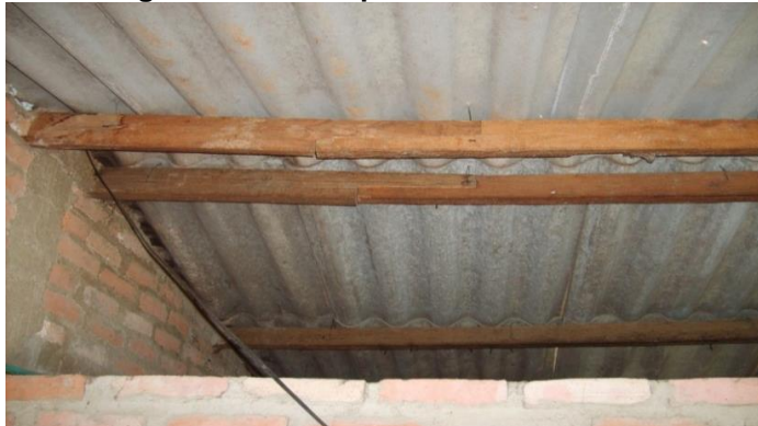
Fotografía 12. Traslapo de correa defectuoso
