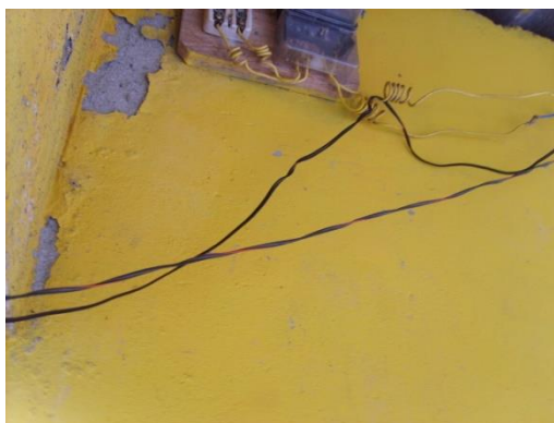
Fotografía 9. Estado actual de las escuelas. Conexiones eléctricas
