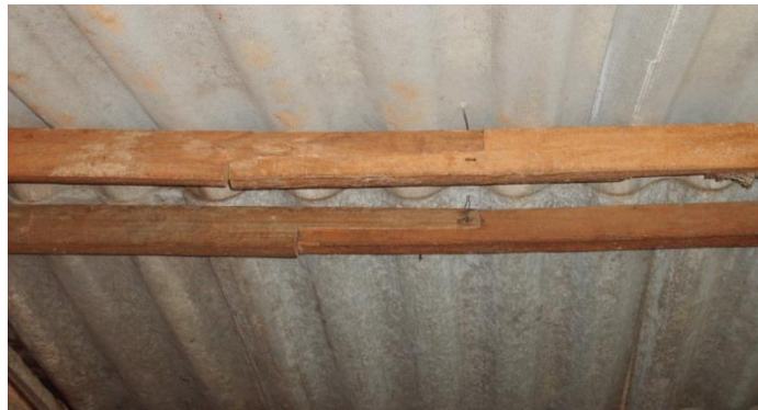
Fotografía 13. Traslapo de correa defectuoso (Acercamiento)
