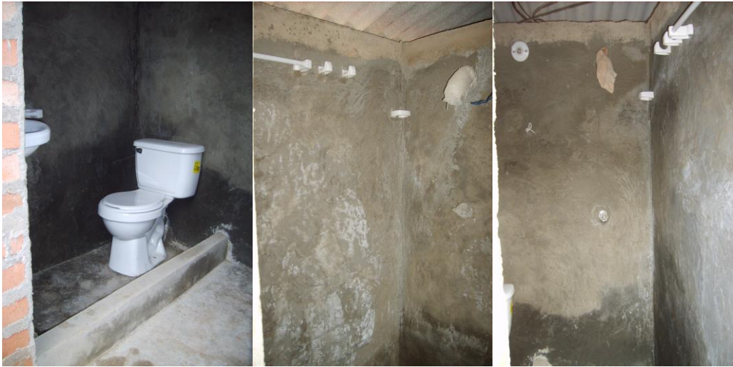
Fotografía 17. Deficiencias en baterías sanitarias.
