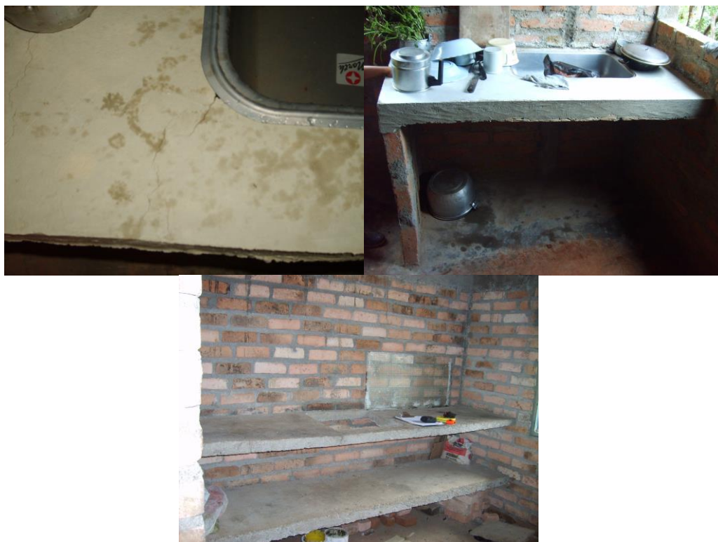
Fotografía 15. Deficiencias en mesones
