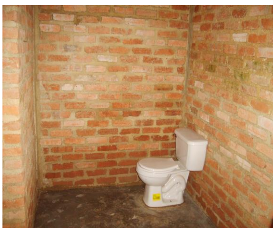
Fotografía 16. Batería sanitaria Incompleta
