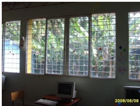
Fotografía 1. Rejas de seguridad en ventanas exigidas por el programa computadores para educar
