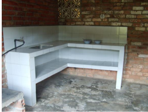
Fotografía 6. Estado actual de las escuelas. Mesón
