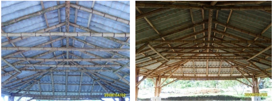
Fotografía 23. Partes de la estructura que presentan grandes deflexiones debido al pequeño diámetro de sus elementos
