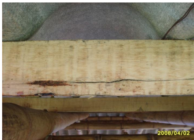
Fotografía 22. Correas que presentaban fisuras (acercamiento)
