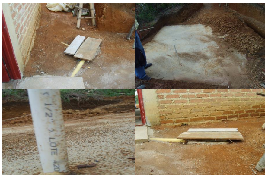
Fotografía 14. Deficiencias en Caja de inspección y pozo séptico.
