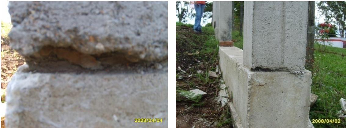
Fotografía 24. Hormigueros en las columnas de la estructura de cerramiento (acercamiento)
