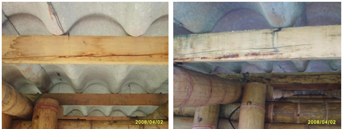
Fotografía 21. Correas que presentaban fisuras
