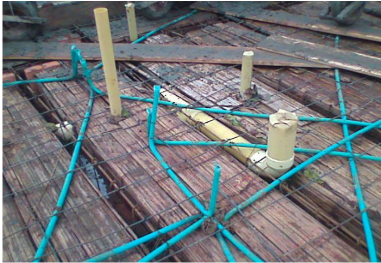
Imagen 10. Desagües segundo piso
