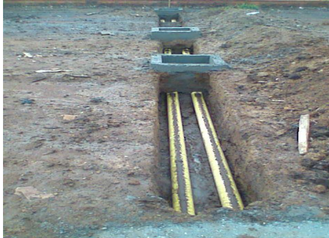
Imagen 8. Tubería de desagüe de 4"
