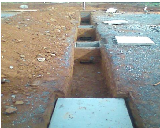
Imagen 6. Cajas de inspección domiciliaria.
