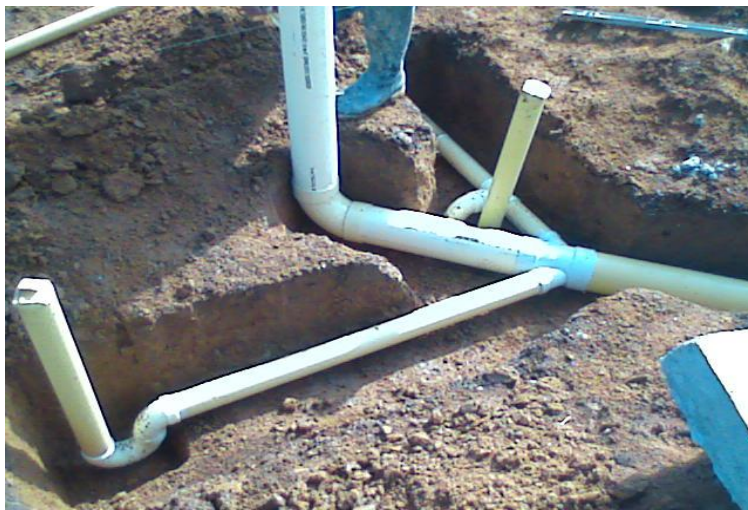
Imagen 9. Ramificación de tubería hidrosanitaria
