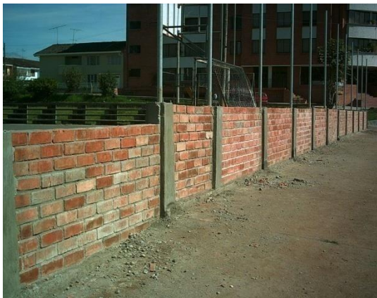
Carlos A. Joaquín M. Figura 3. Adecuación de muro para montaje de malla
