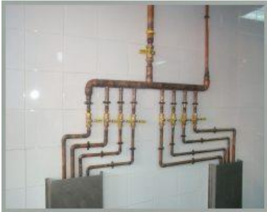
FOTOGRAFIA No. 3 INSTALACION DOMICILIARIA
