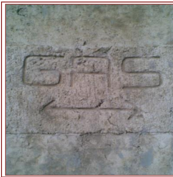
FOTOGRAFIA No. 34 MARQUILLAS DE GAS TIPO I
