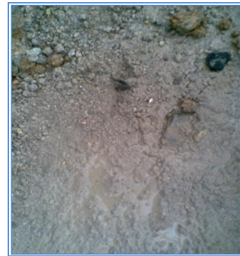
FOTOGRAFIA No. 41 COMPACTACION MENOR AL 92%
