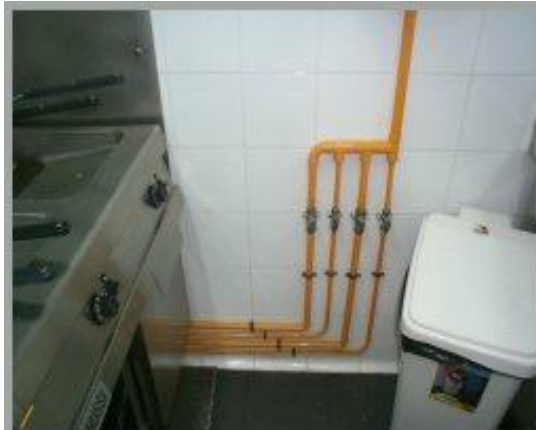
FOTOGRAFIA No. 4 INSTALACION INTERNA – INDUSTRIAL
