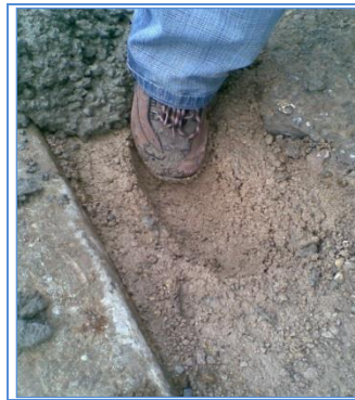
FOTOGRAFIA No. 40 COMPACTACION MENOR AL 85%
