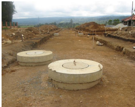
Figura 4. Cámaras de recolección para aguas lluvias y aguas residuales de forma separada y sumideros en los cruces de las calles.
