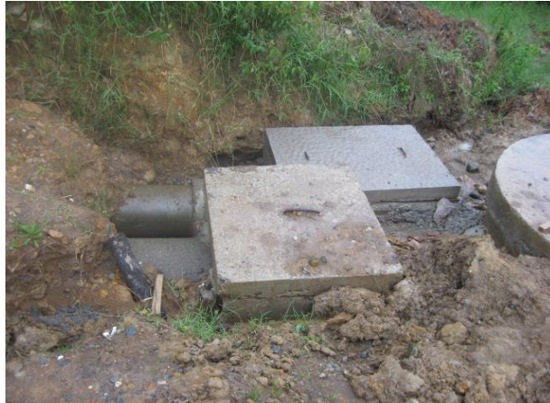
Figura 3. Cajas de cambio de pendiente y dirección para aguas lluvias y aguas residuales.
