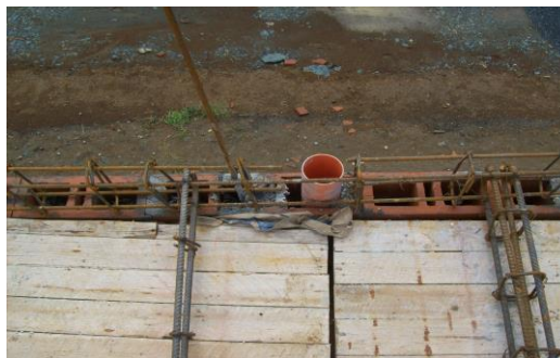
Foto 18. Corte indebido de varilla superior del castillo
