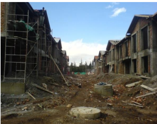
Foto 72. Desorden en la obra
