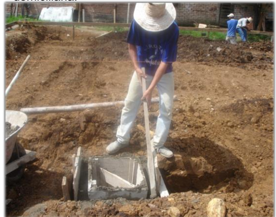
Foto 3. Obrero apisonando la mezcla. Se observa el hilo de referencia, que indica la altura a la que debe quedar la caja domiciliaria.
