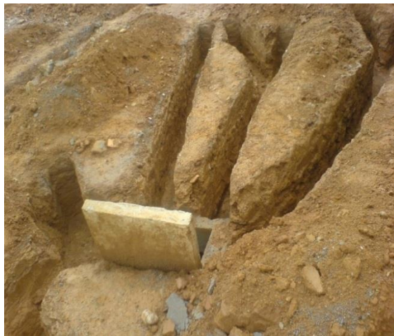
Foto 9. Caja domiciliaria y ramificaciones correspondientes a la tubería de los desagües
