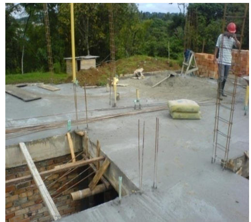
Foto 38. Losa de entrepiso
