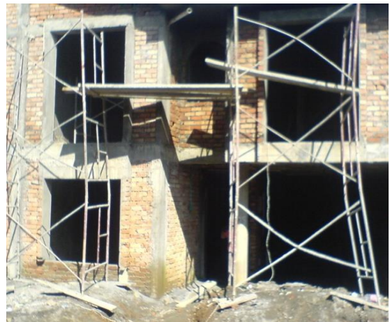
Foto 76. Andamio en mal estado
