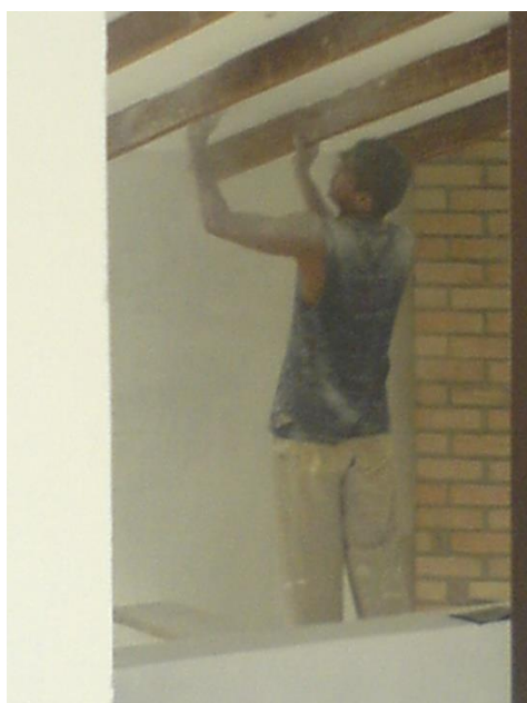
Foto 83. Obrero sin ninguna protección
