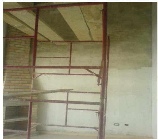
Foto 78. Andamio en buen estado
