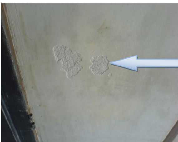
Foto 58. Estuco reventado por el exceso de calor generado por el soplete
