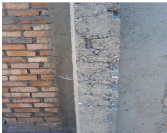
Foto 31. Columna con hormiguo excesivo
