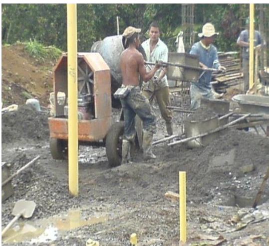
Foto 110. Obreros que no utilizaron los equipos de protección de protección
