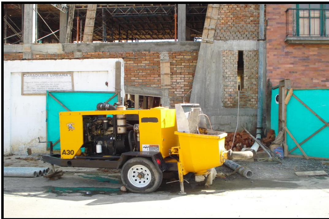
FOTO 2. BOMBA ESTACIONARIA Y TUBERIA ARMADA
