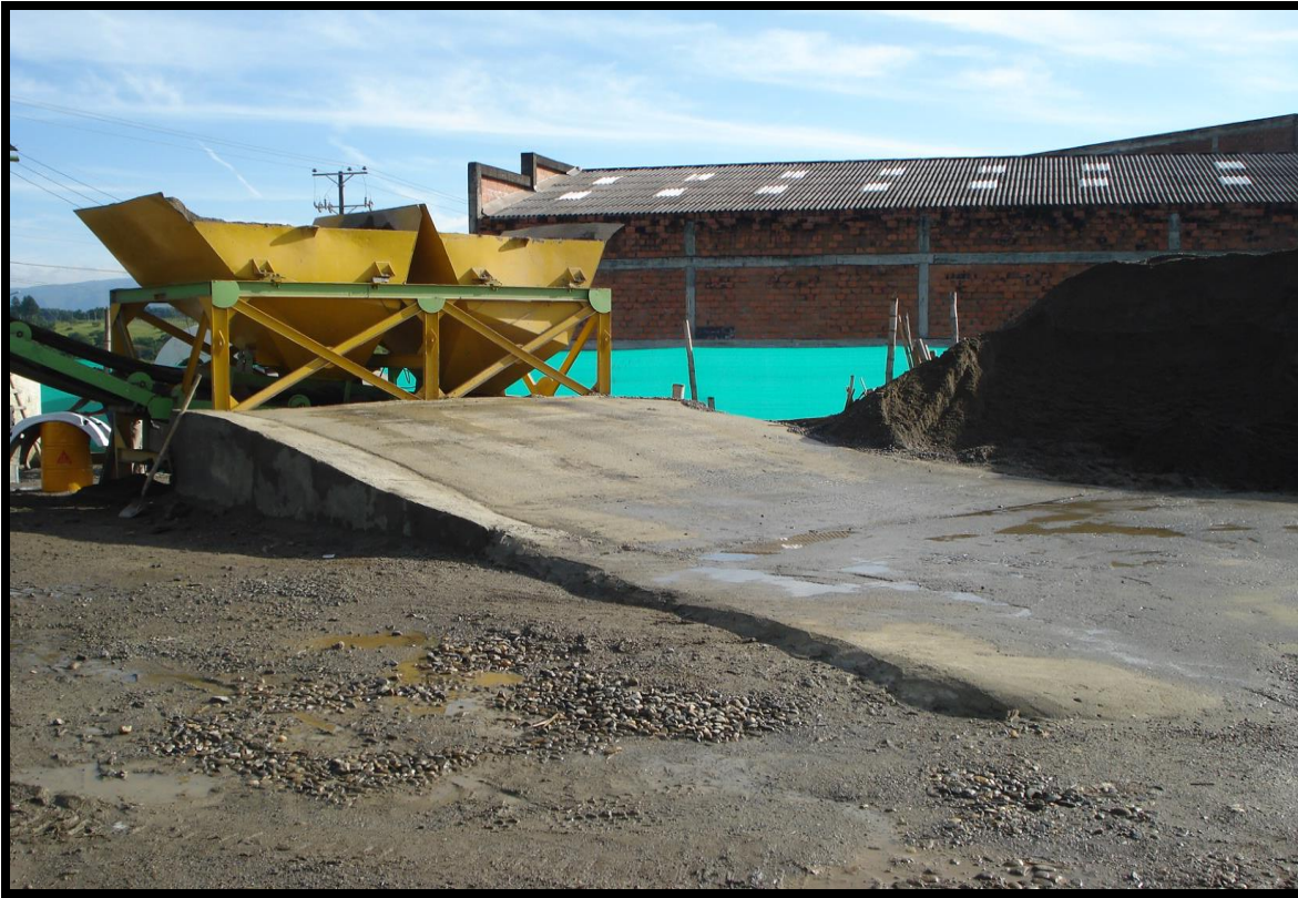
FOTO 14. TOLVAS PARA DOSIFICACION DE AGREGADOS
