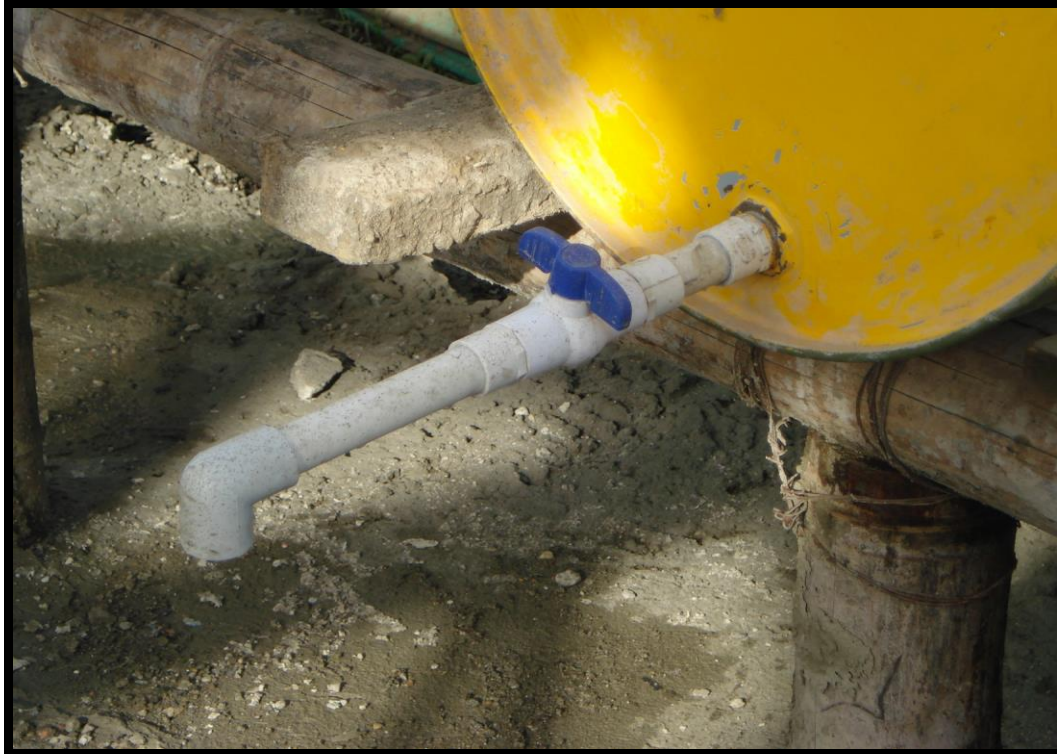
FOTO 13. SISTEMA DE DOSIFICACION DE ADITIVOS
