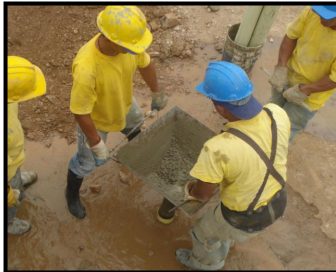
FOTO 54. CONCRETO BAJANDO POR LA TUBERIA
