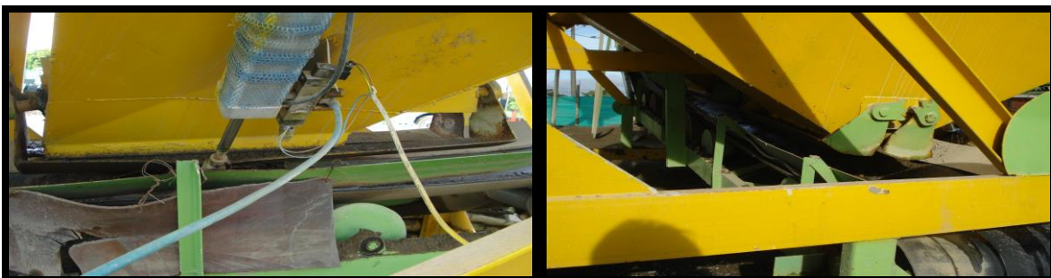
FOTO 20. COMPUERTAS DE CONTROL DE LAS TOLVAS DE AGREGADOS
