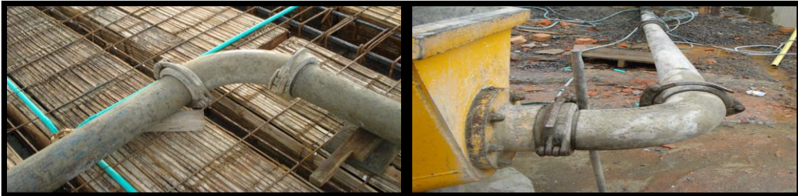
FOTO 34. DETALLE DE CODOS ACOPLADOS A LA TUBERIA
