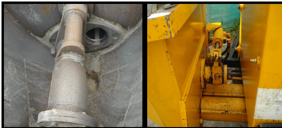
FOTO 39. MECANISMO DE BOMBEO
