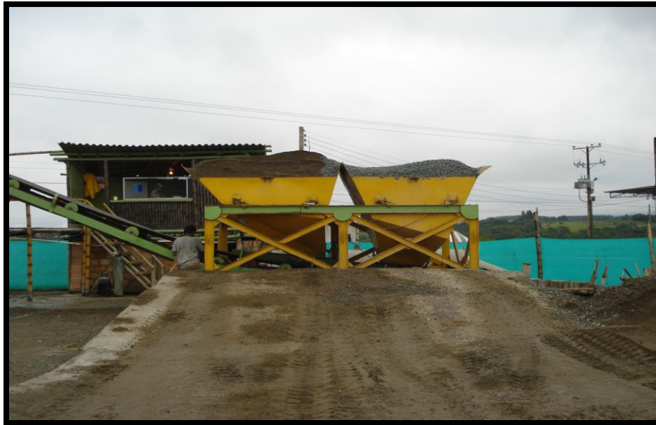
FOTO 17. TOLVAS LLENAS CON AGREGADOS
