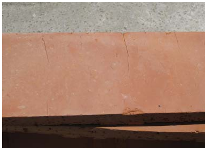
Figura 49. Ladrillos con fracturas
