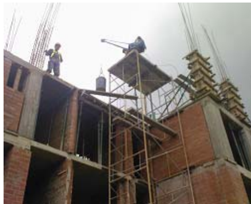
Figura 33. Transporte del concreto hecho en obra por medio de pluma grúa con cucharón
