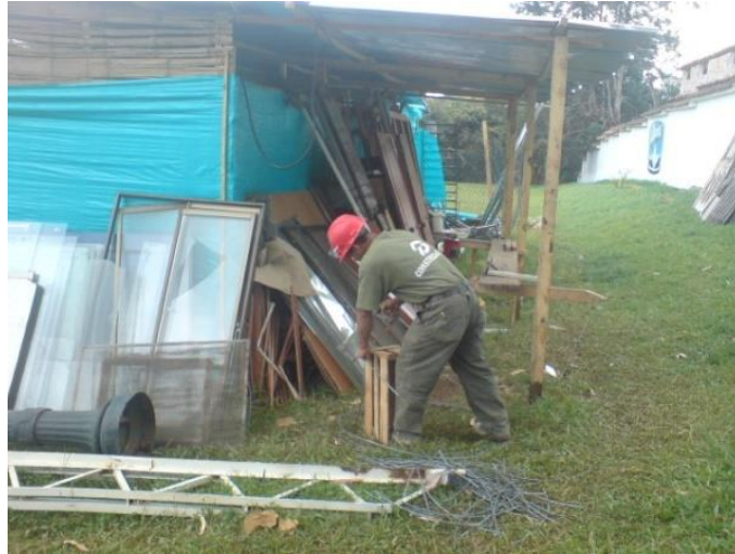
Fotografía 14. Deficiente ubicación de objetos desmontados
