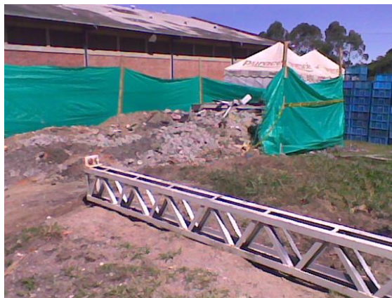
Fotografía 15. Incorrecta ubicación de escombros
