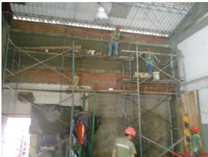
Fotografía 7. Trabajo en alturas sin las medidas de protección requeridas
