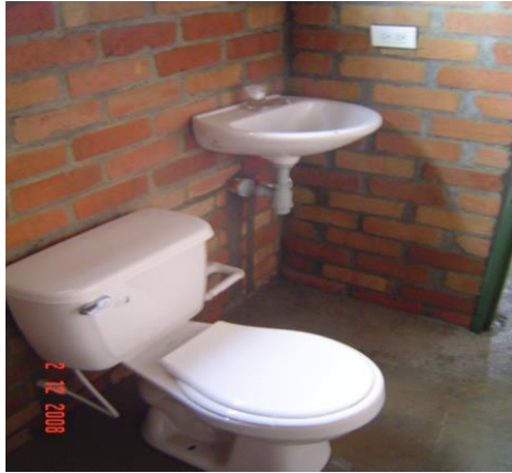
BAÑO Y LAVAMANOS
