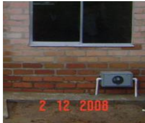
CONTADOR DE AGUA POTABLE
