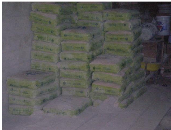
Figura 80. Almacenamiento del cemento Argos tipo 1
