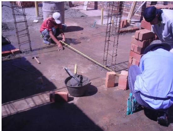
Figura 18. Flexómetro utilizado para medir la distancia a la que iban a quedar localizados dos muros de ladrillo
