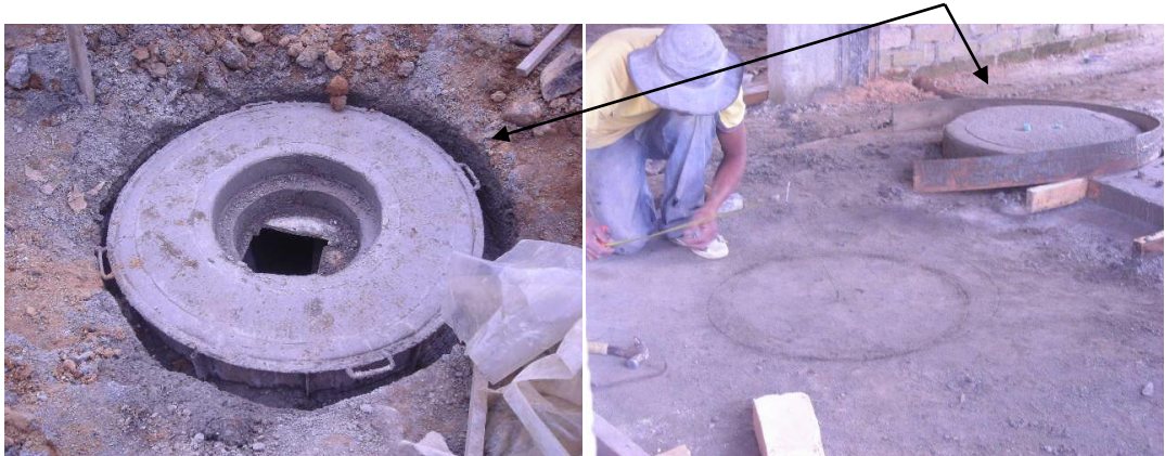
Figura 70. Tapas de las cámaras de inspección
