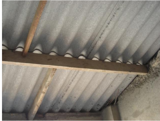
Figura 59. Ubicación de las hojas de asbesto cemento
