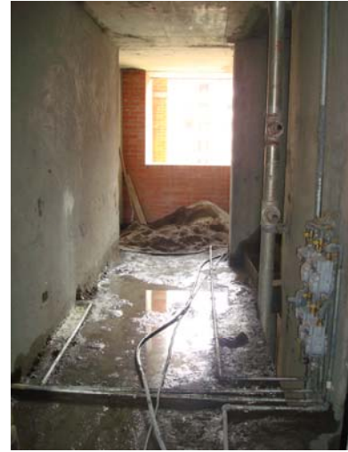
Punto fijo, Tubería de gas y red contra incendio
