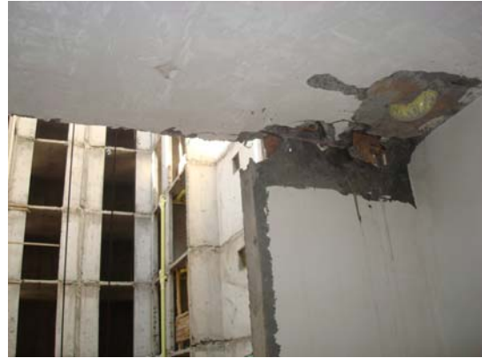
Unión de muro en outinord y placa expuesta y tubería que sale de la placa
