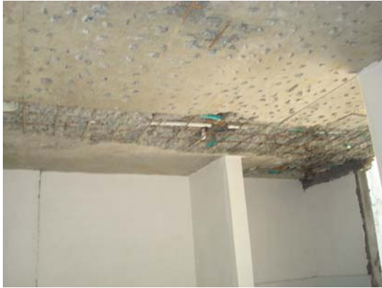
Malla de refuerzo expuesta, debido a una mala colocación y una deficiente vibración
