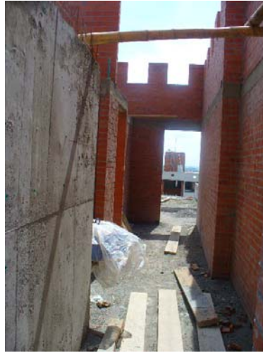
Cuarto de maquinas
