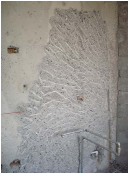
Superficie irregular en muros en outinord
