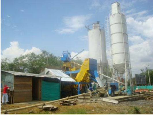
Planta de concreto
