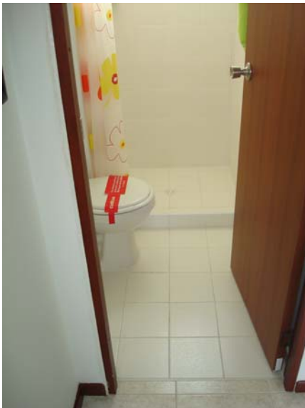
Baño: vemos la puerta arquitectónica, los marcos en madera, el enchape en guaruja blanco y los aparatos sanitarios.
