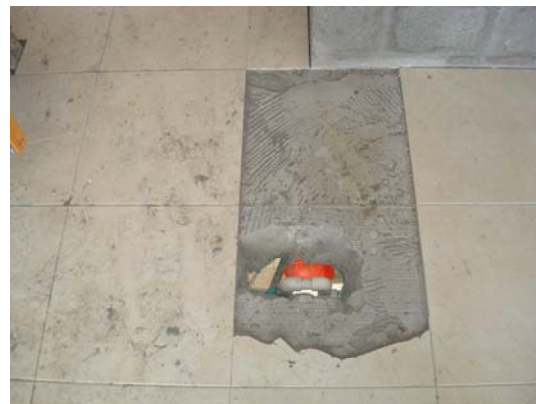
Detalles de tubería que influyen en la placa y en el enchape
