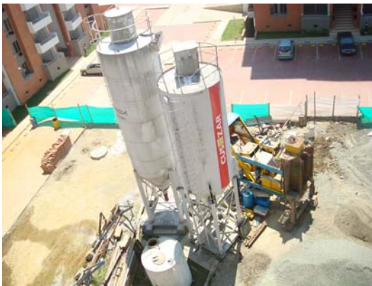
Planta de concreto
