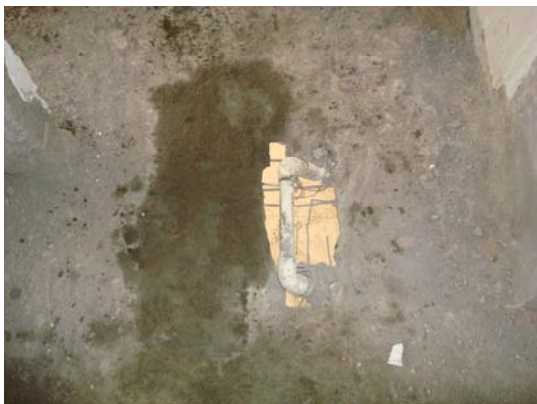
Abertura en placa debido a la tubería
