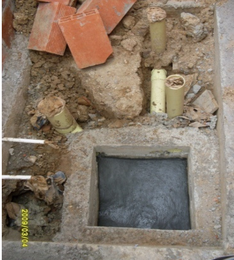
Foto 35. Cañuelas para evacuación de aguas sanitarias.
