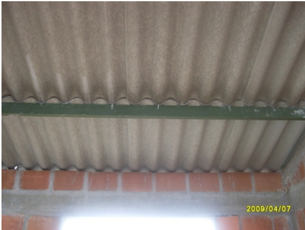
Foto 72. Fijación de la cubierta a los perfiles metálicos por medio de ganchos
