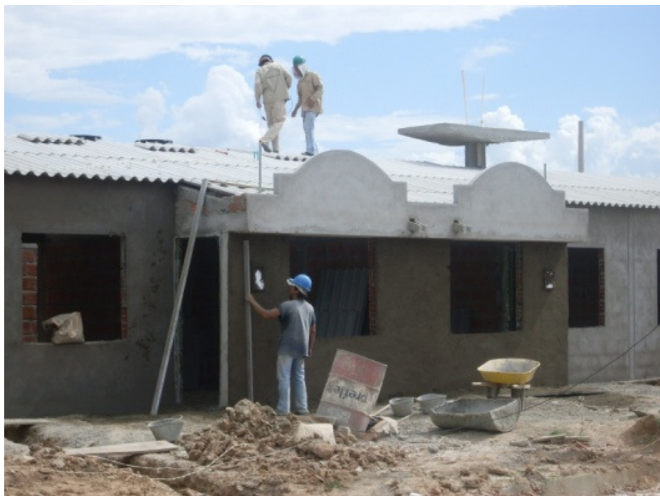
Foto 66. Pañete de fachadas
