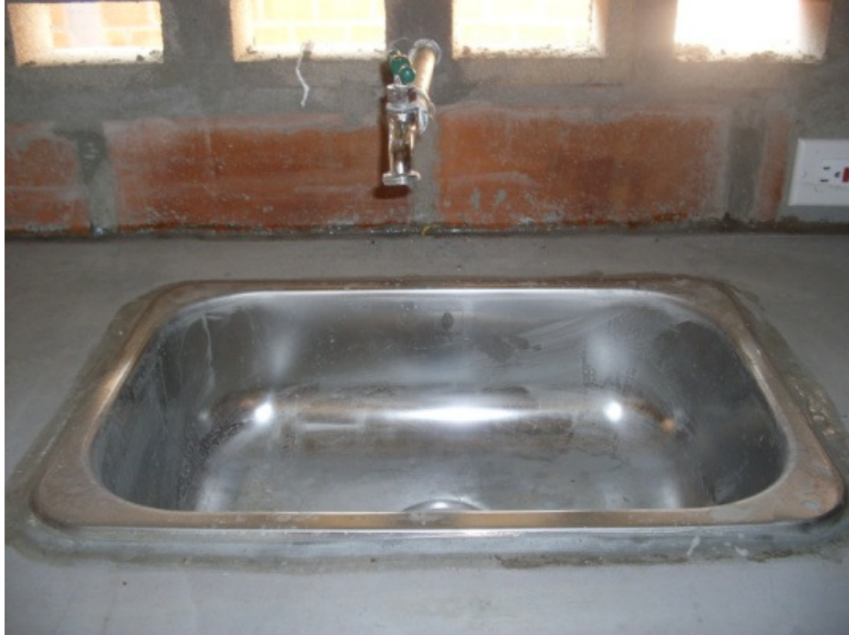
Foto 120. Lavaplatos y llave terminal
