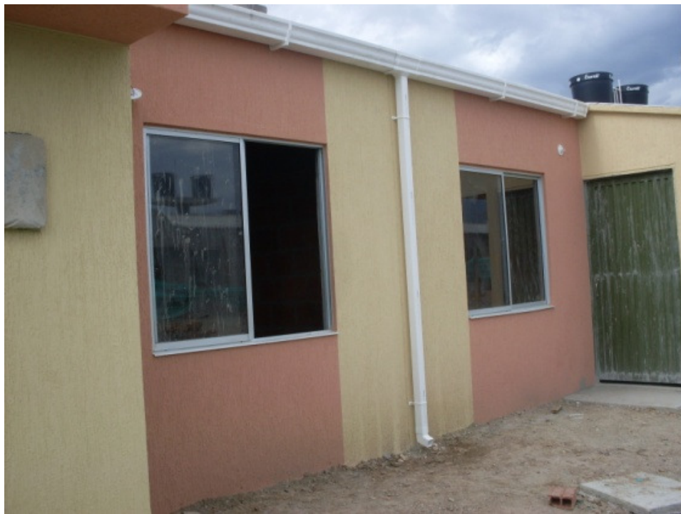
Foto 108. Canaleta y bajante para aguas lluvias
