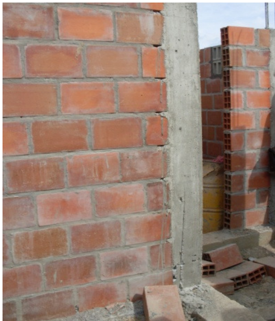
Foto 39. Columna recién desencofrada, con porosidades
