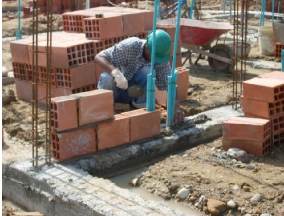
Foto 113. Tubería eléctrica atravesando la mampostería
