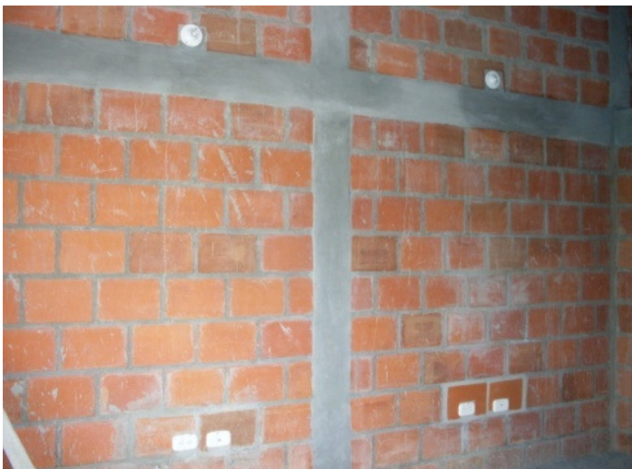
Foto 116. Salidas eléctricas en sala-comedor
