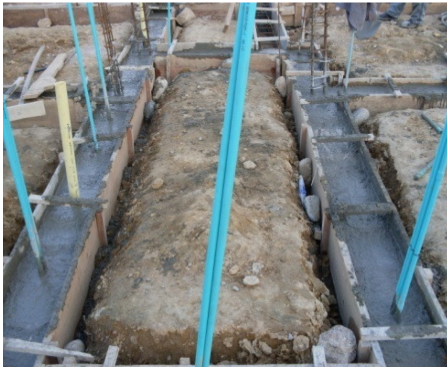
Foto 23. Bajantes sanitarios, tubería eléctrica y castillos de columnas anclados en las vigas.
