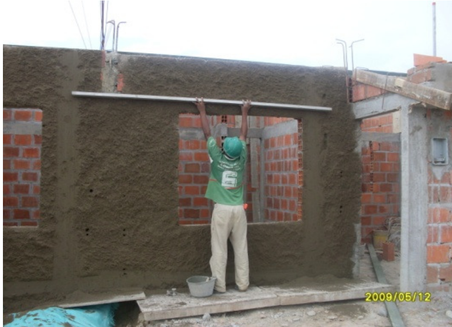
Foto 65. Pañete de fachadas
