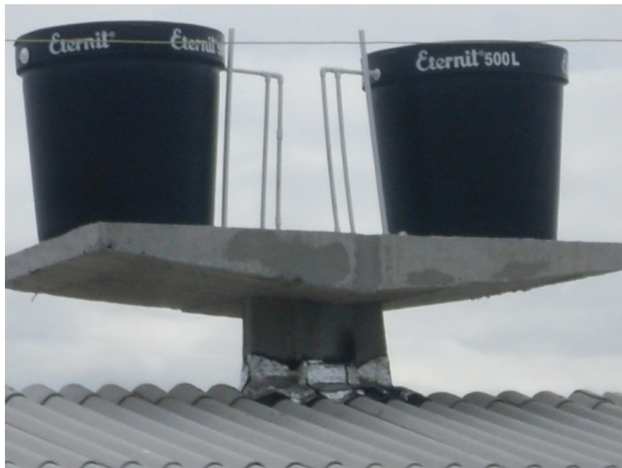
Foto 84. Placa Tanque en servicio. Detalle del flanche en la columna
