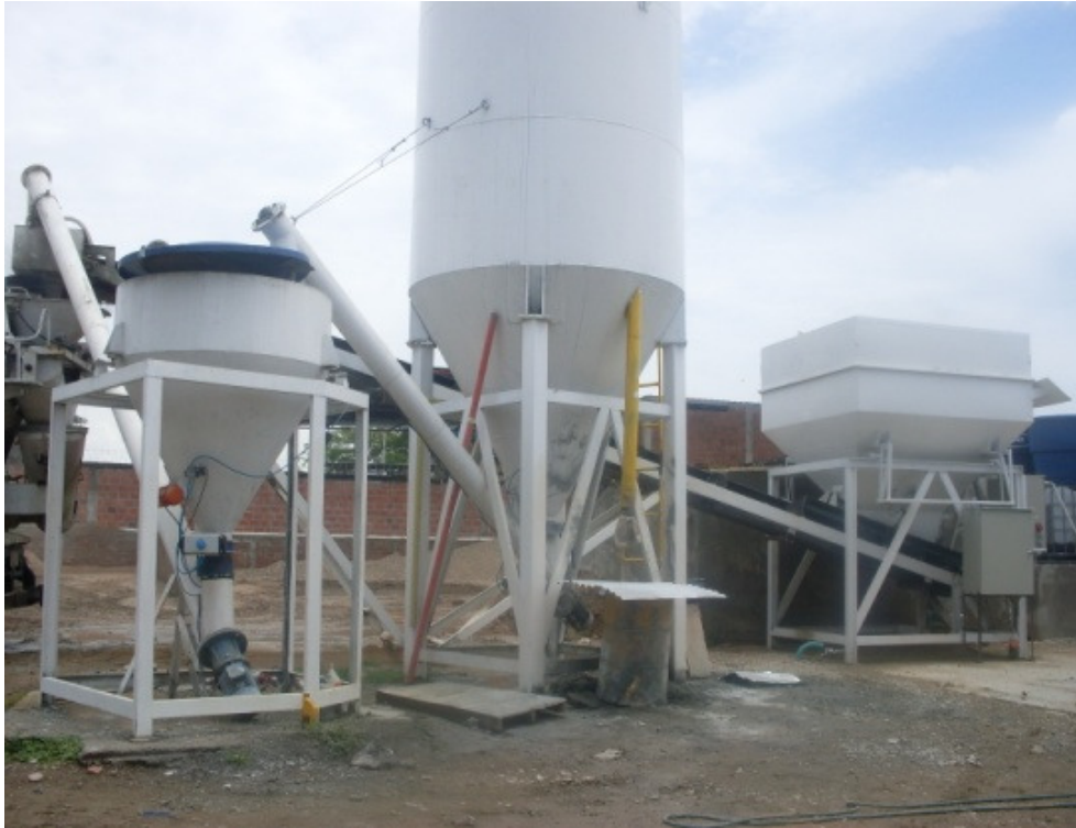
Foto 8. Planta de Concreto de PROYECONT.
