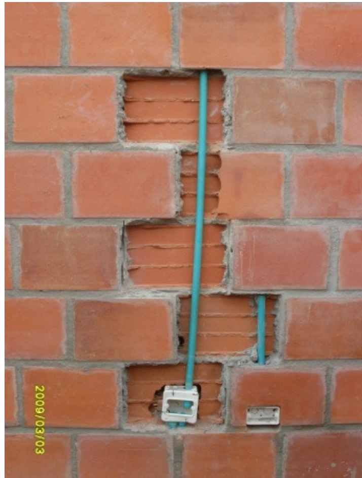
Foto 114. Caja de salida eléctrica 2400
