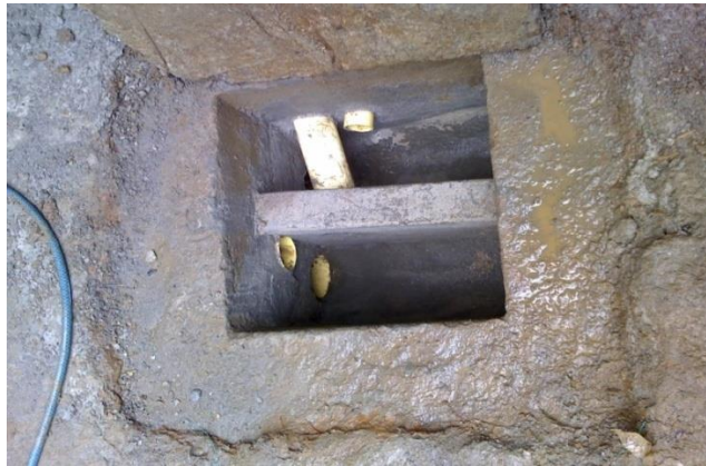
Cámara con cañuelas para aguas lluvias y servidas
