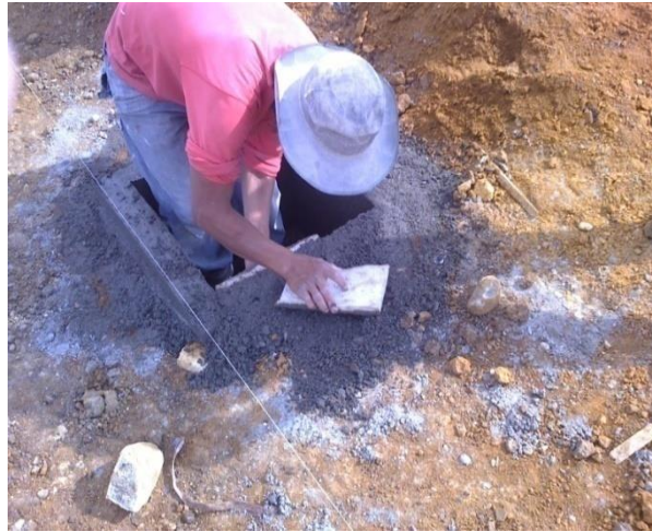
Platachado de los bordes de la cámara de inspección.
