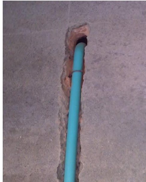
Ubicación de la tubería sostenida por clavos
