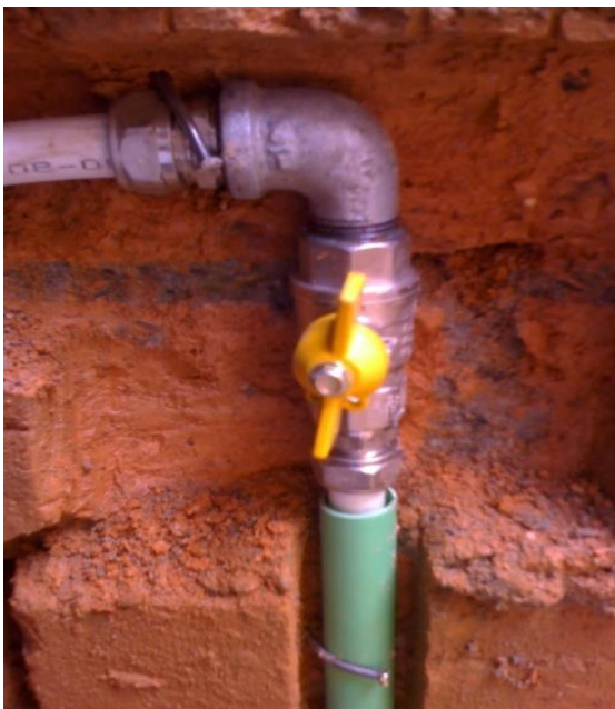
Válvulas en acero galvanizado
