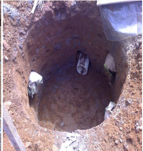
Ubicación de tubería saliente y de llegada a la cámara de inspección.
