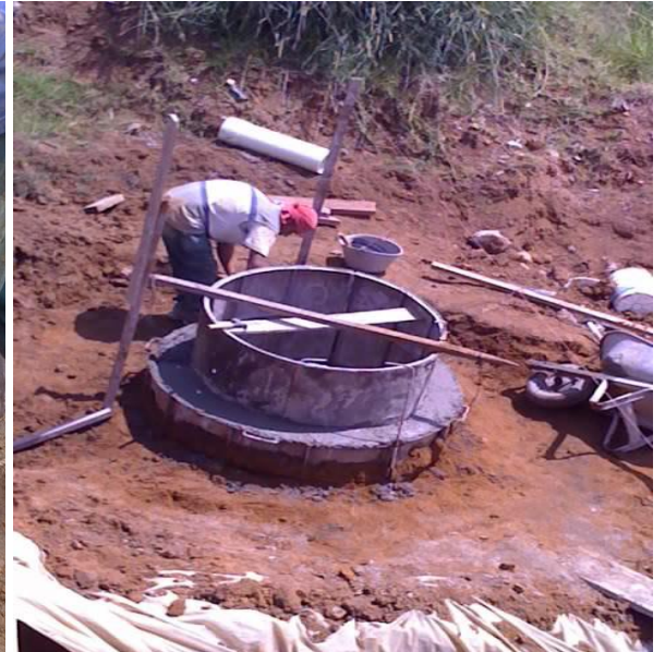
Cámara fundida sin tapa.
