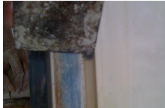
Dilatación de puertas
