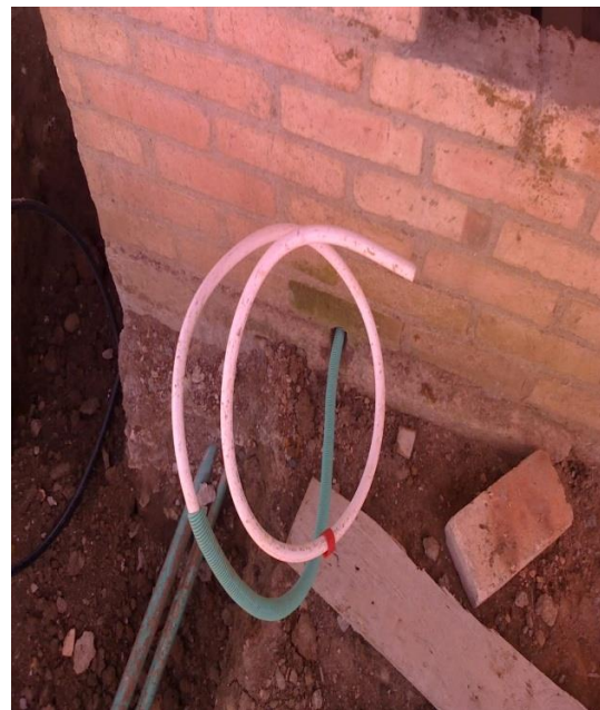
Tubería para instalación domiciliaria de gas
