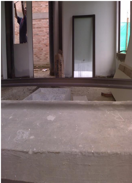
Curvatura de los marcos antes de ser atornillados
