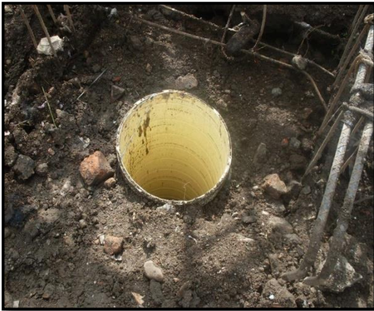
Foto 17. Pilote No 80 sin agua en su interior
