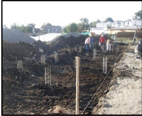
Foto 35. Excavación a mano para empezar con la construcción de la losa de cimentación de la torre C.
