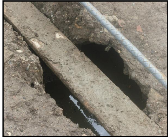
Foto 16. Pilote No 64 lleno de agua
