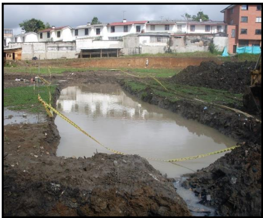
Foto 21. Agua proveniente del pozo
