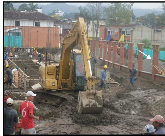
Foto 62. Cerramiento calle 5N, sin instalación de rejas
