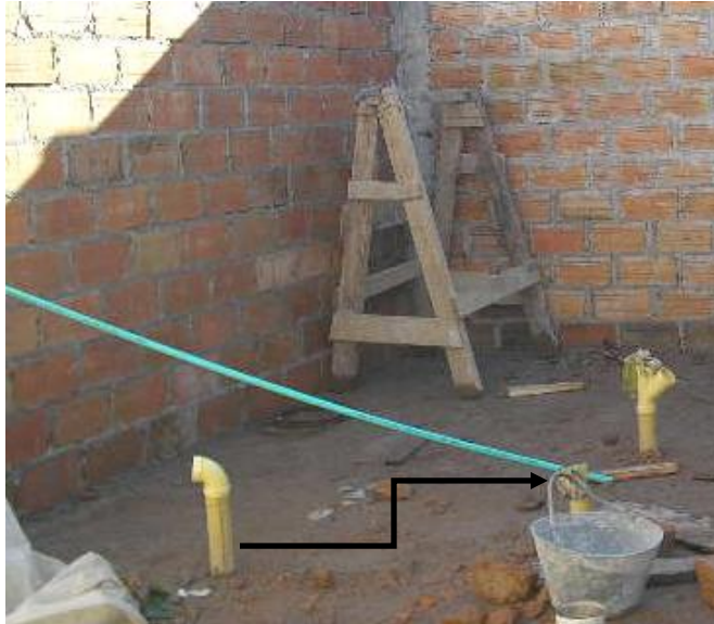
Tuberías de desagüe de aparatos sanitarios
