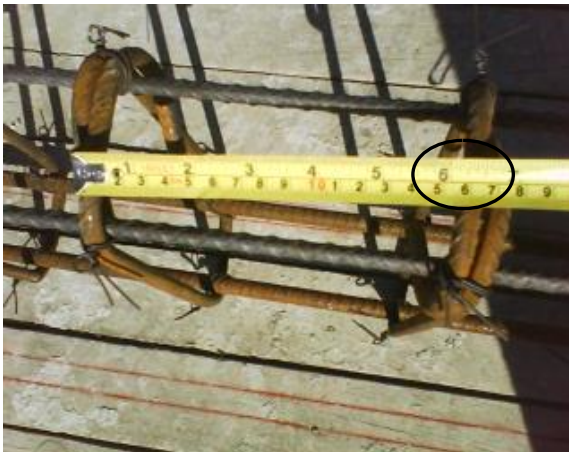
Figura 93. Estribo que no cumple con la separación
