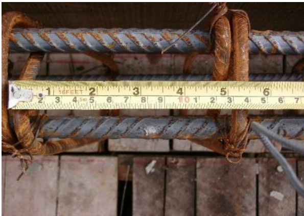
Figura 32. Separación entre estribos
