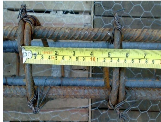
Figura 35. Separación entre estribos
