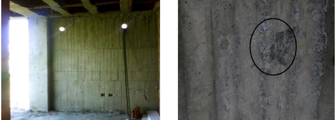
Figura 153. Defectos en los muros
