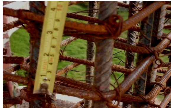
Figura 58. Separación entre estribos
