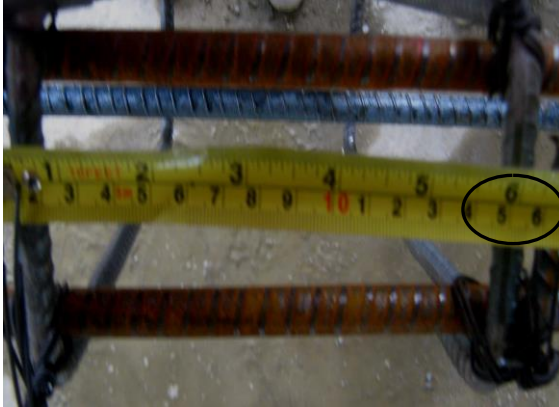
Figura 102. Separación entre estribos
