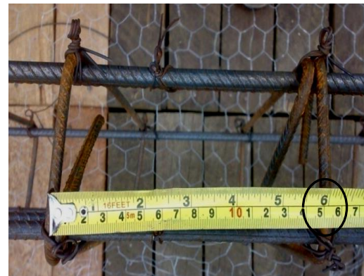
Figura 37. Separación entre estribos
