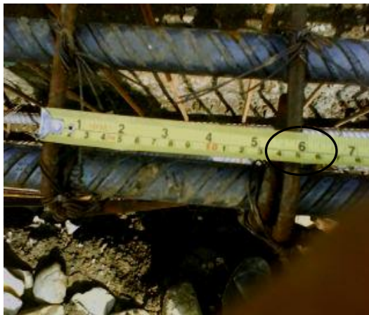
Figura 114. Separación entre estribos
