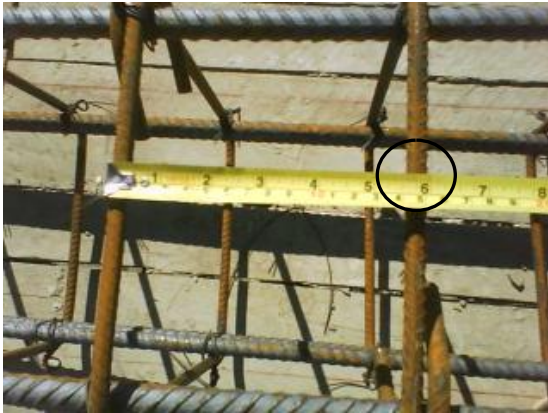
Figura 96. Separación entre estribos
