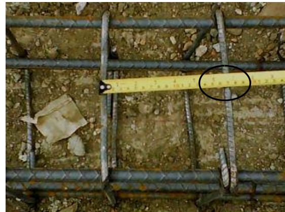
Figura 136. Separación entre estribos
