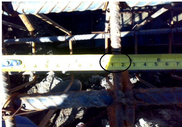
Figura 118. Estribo que no cumple con la separación
