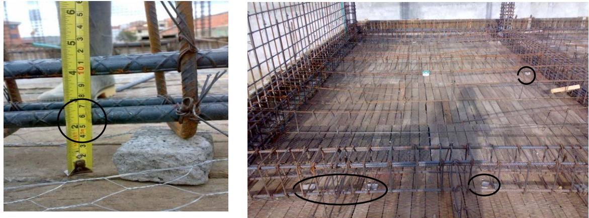
Figura 23. "Panelas" o trozos de concreto
