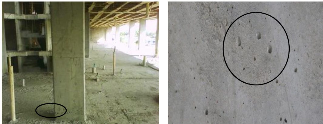
Figura 154. Hormigueros en columnas
