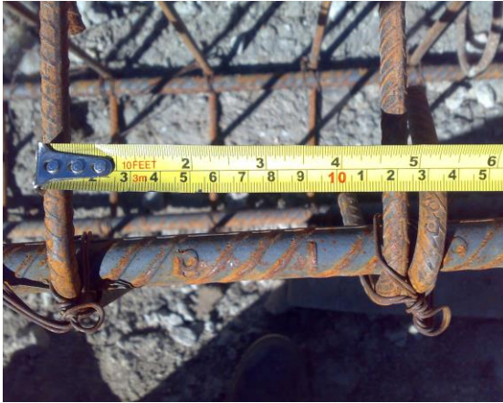
Figura 124. Separación entre estribos
