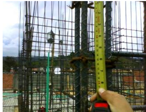
Figura 80. Separación entre estribos
