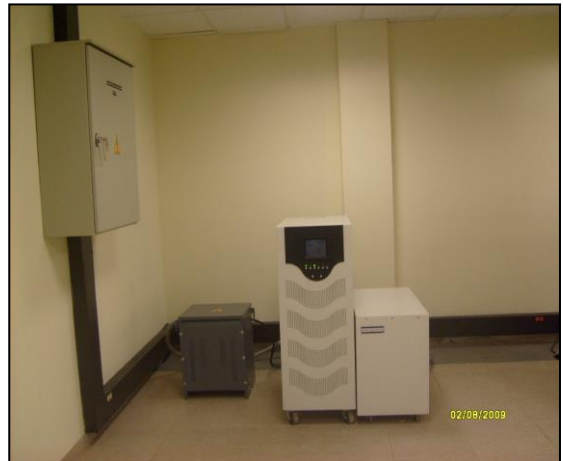
Imagen 18. Cuarto de equipos
