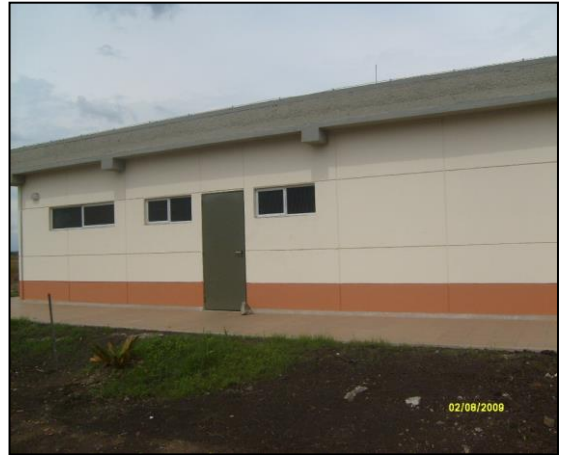
Imagen 20. Salida de emergencias de central de cámaras
