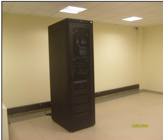
Imagen 17. Cuarto de equipos y cielo raso en dry wall
