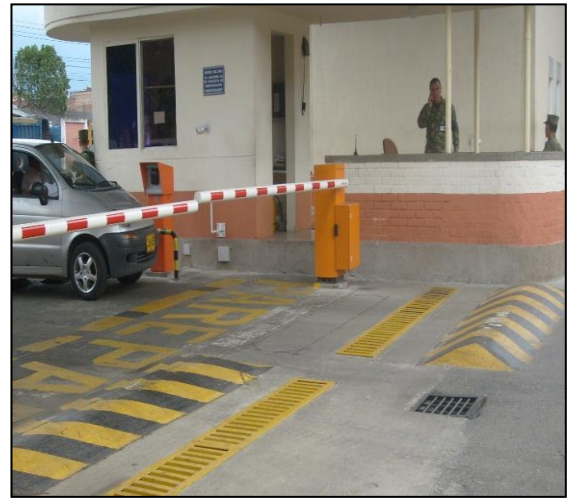
Imagen 53. Talanquera de entrada en funcionamiento
