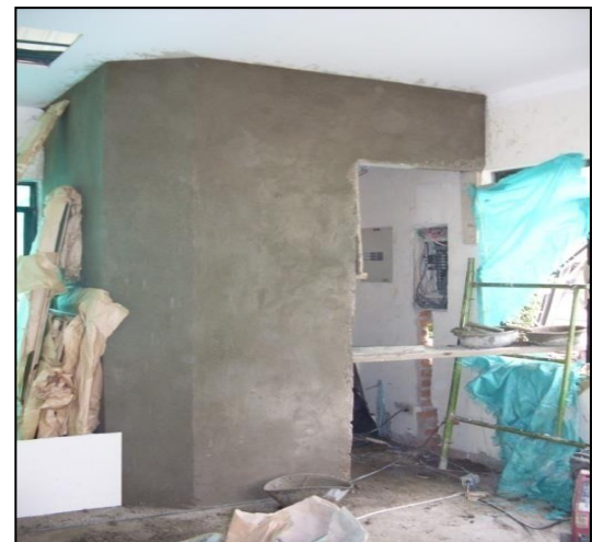
Imagen 27. Pañete del cuarto de la UPS
