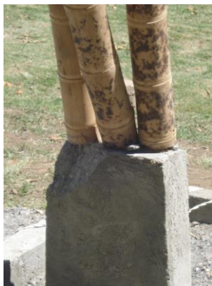
Figura 48. Descascaramiento de esquina en pedestal
