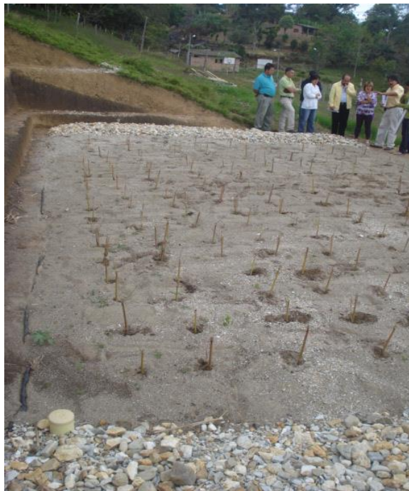
Figura 31. Foto panorámica del biofiltro
