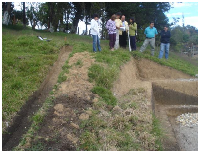
Figura 34. Canal parte exterior del biofiltro
