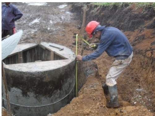
Figura 37. Chequeo cota tapa cámara.
