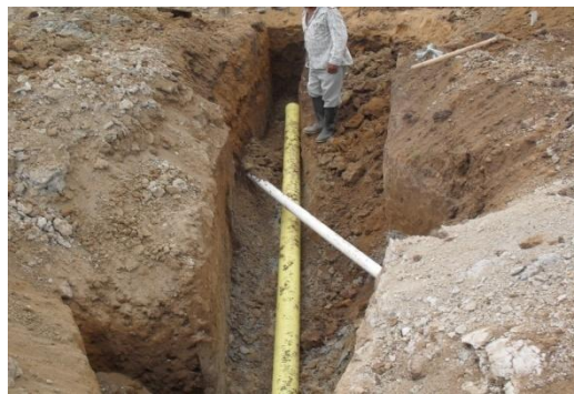
Figura 11. Tubería de acueducto
