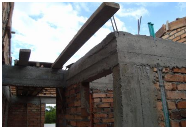
Figura 34: Vigas de amarre del segundo piso, casa 52.
