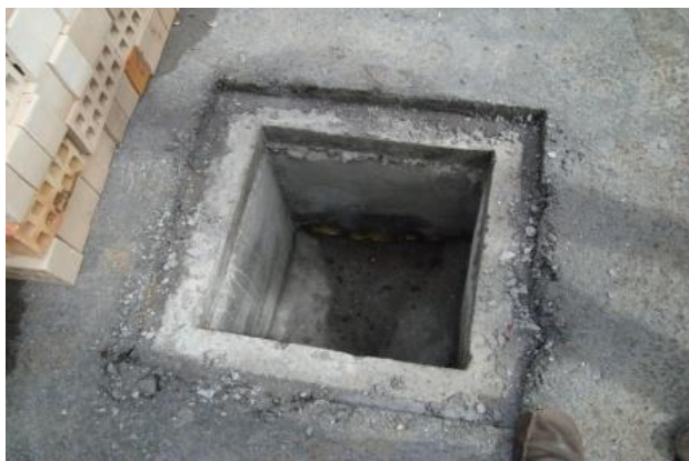
Figura 23: Caja de inspección, casa 52.
