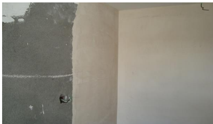
Figura 44: Estuco de muros casa 42.
