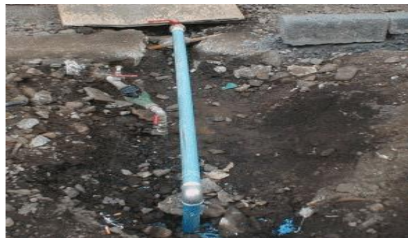
Figura 37: Acometida Hidráulica casa 42.
