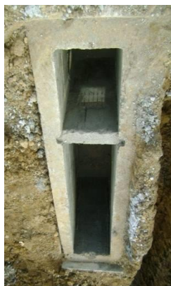
Foto No. 26 Sumideros con Desarenador
