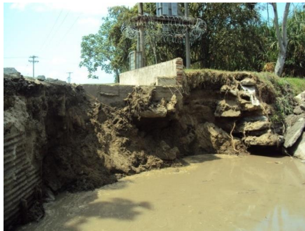
Foto 41. Colapso de la estructura
