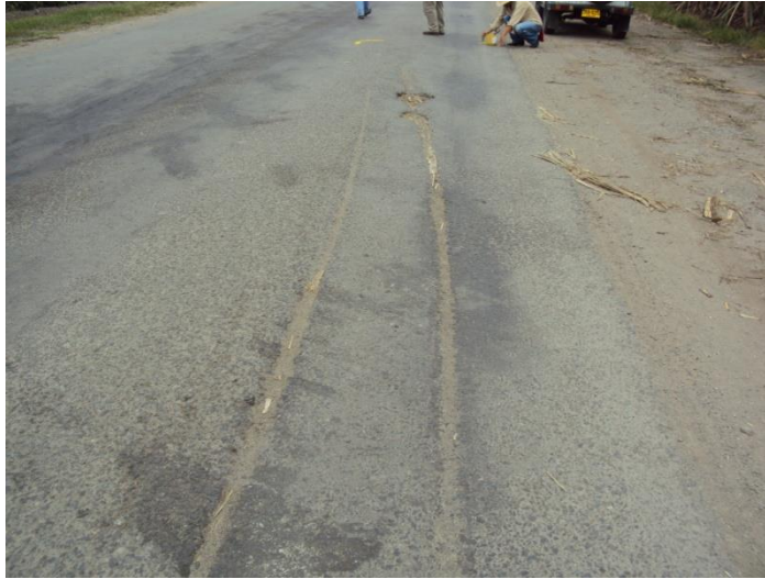
Foto 33. Marcación de daño.
