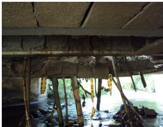
Foto 45. Daños en pontón.
