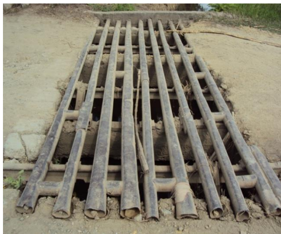
Foto 51. Daños en quiebrapatas
