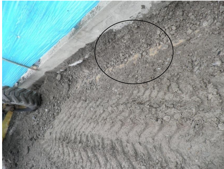
Fotografía No. 8 Humedad en material de Sub-base K0 + 160
