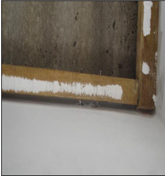
Ilustración 16. . Estructura en madera no está bien sujeta.
