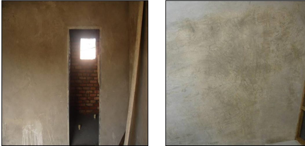
Ilustración 24. Paredes estucadas en las que se observa la humedad y color amarillento
