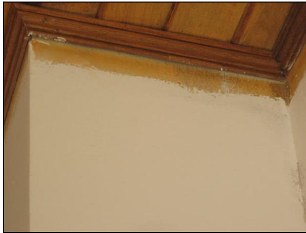
Ilustración 73. Paredes deterioradas por la pintura de madera.
