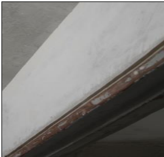
Ilustración 65. Dilataciones en el marco de una puerta.
