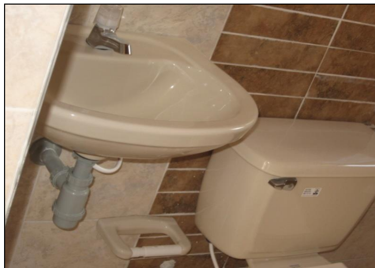
Ilustración 54. Lavamanos e inodoro instalados correctamente.
