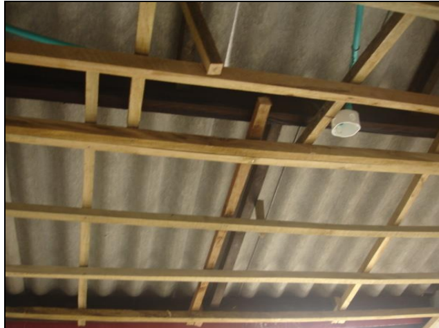
Ilustración 13. Estructura en madera mal instalada
