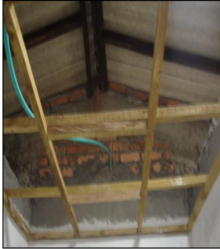
Ilustración 15. Estructura muy separada Ilustración 17a. Estructura bien instalada.
