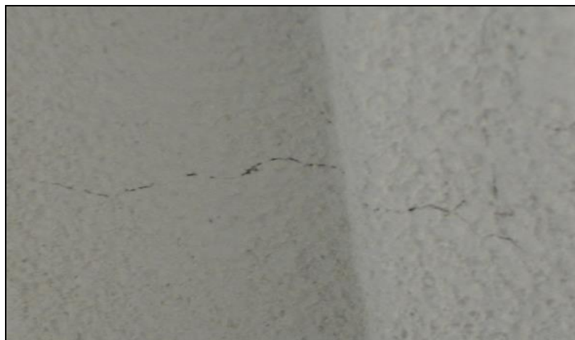
Ilustración 42. Cielo raso con fisuras.
