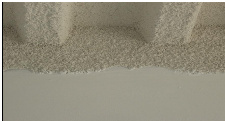
Ilustración 43. Cielo raso con bordes desalineados.
