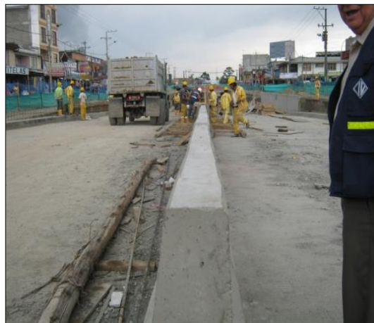
Ondulamiento en el separador
