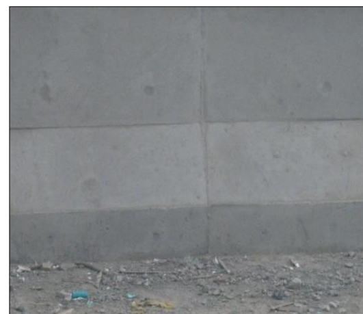
Corrección del hormigqueo en el separador
