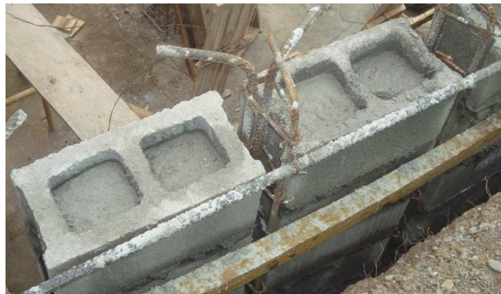
Figura 44. Celdas del bloque fundidas
