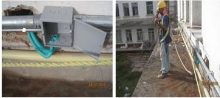
Fig. 15 Tuberías red de diálisis
