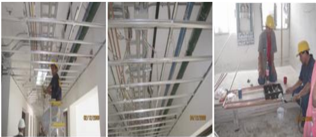
Fig. 11 Redes de gases, voz y datos y eléctrica.
